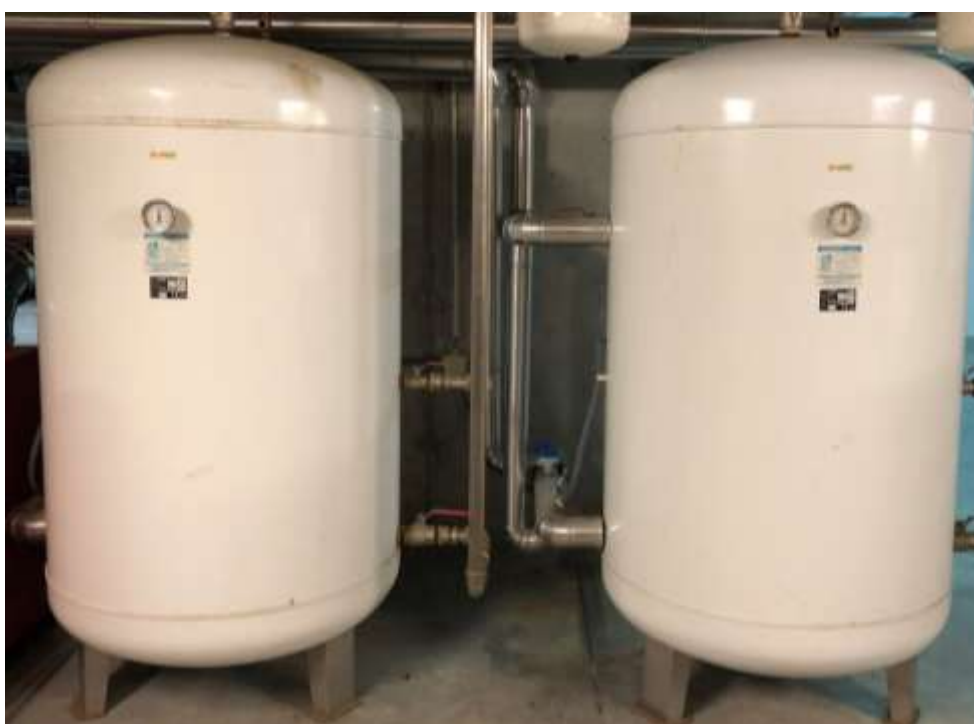
Figura 11 -Termoacumuladores de 1000L cada para aquecimento das AQS.
