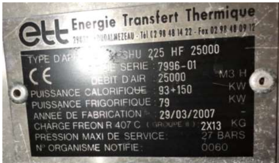
Figura 8 - Placa de identificação do equipamento de climatização.
