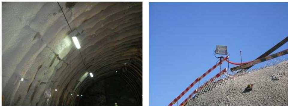
Figura 94 - Lâmpada fluorescentes para iluminação do interior do túnel e holofote de iluminação exterior.
