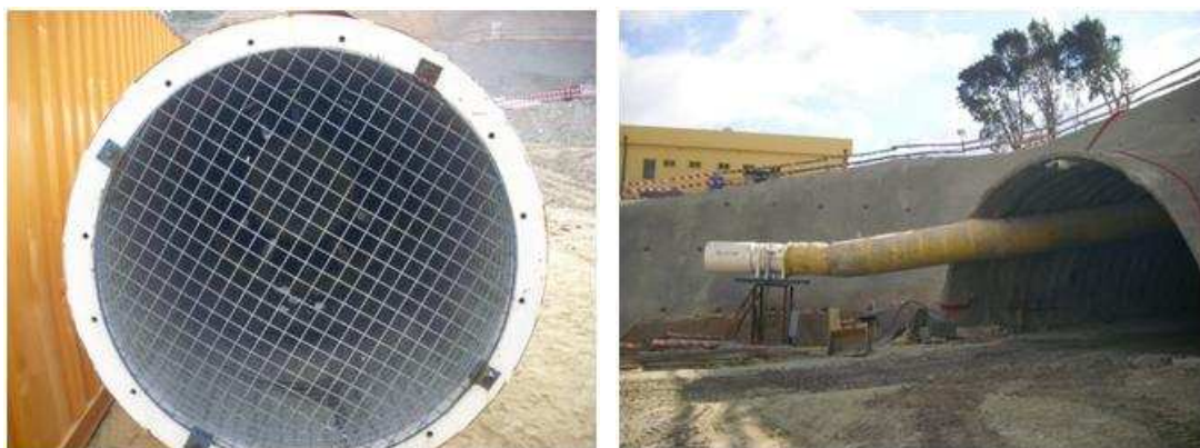
Figura 88 - Equipamento de ventilação, instalado na galeria Norte do emboquilhamento de saída.
