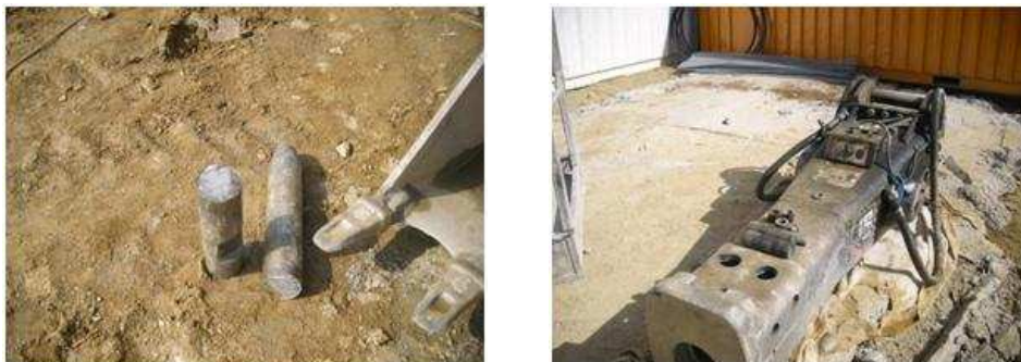
Figura 127 – Ferramenta de corte quebrada e martelo avariado.
