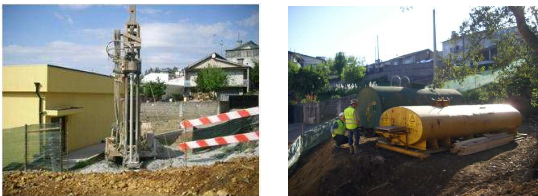
Figura 91 - Furo de captação na frente poente e depósitos para armazenamento de água.
