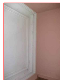
-1- Fenda na ligação Parede Teto
