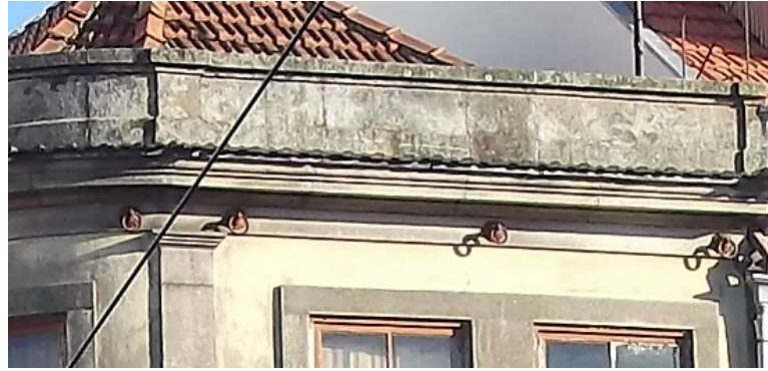
Figura 3.4.: Pormenor da Parede da Fachada no nível do desvão da cobertura, referida na 3.3 mas pelo exterior
