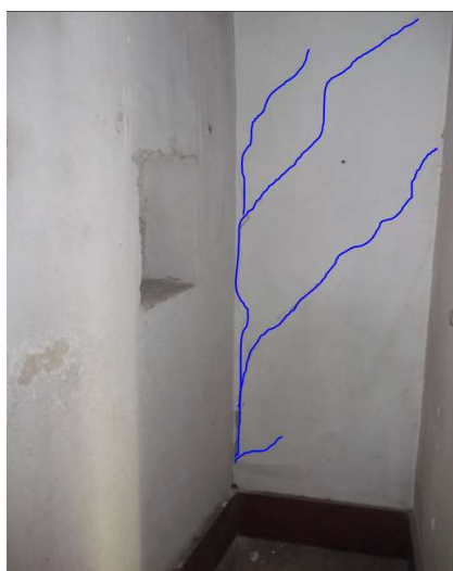
Figura 4.6.: Fissuração devido à rotação do apoio da parede(vigas do pavimento)
