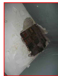
-5- Infiltração Água Teto
