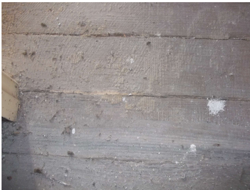
Figura 4.3.: Pormenor do estado do soalho ao nível do 1º andar
