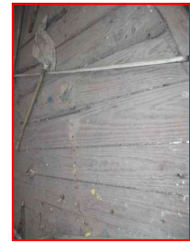
-3- Soalho Muito Degradado
