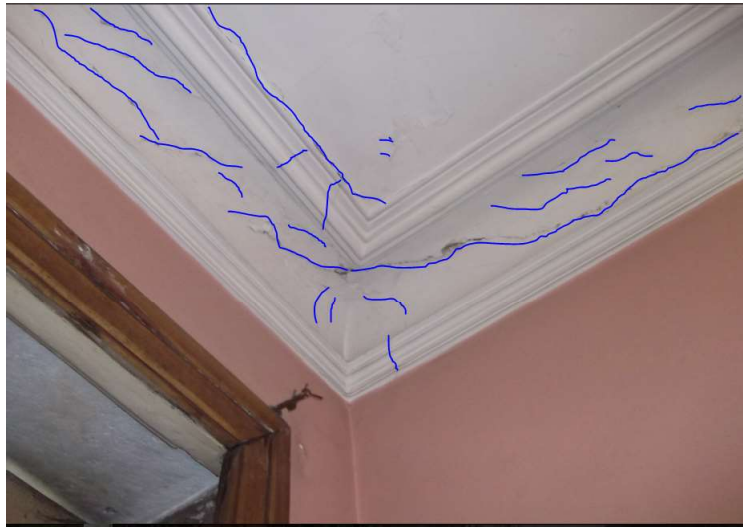
Figura 4.7.: Fissuração devido à rotação do apoio da parede (vigas do pavimento)
