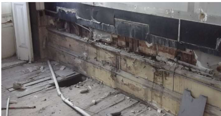
Figura 4.2.: Degradação da parede e do soalho (compartimento do 1º andar) devido há ação do homem no 1º andar
