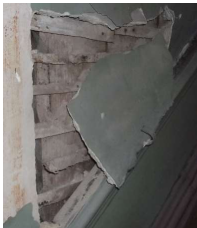
Figura 3.8.: Pormenor da Parede de Tabique nas escadas de acesso do R/c para o 1º andar
