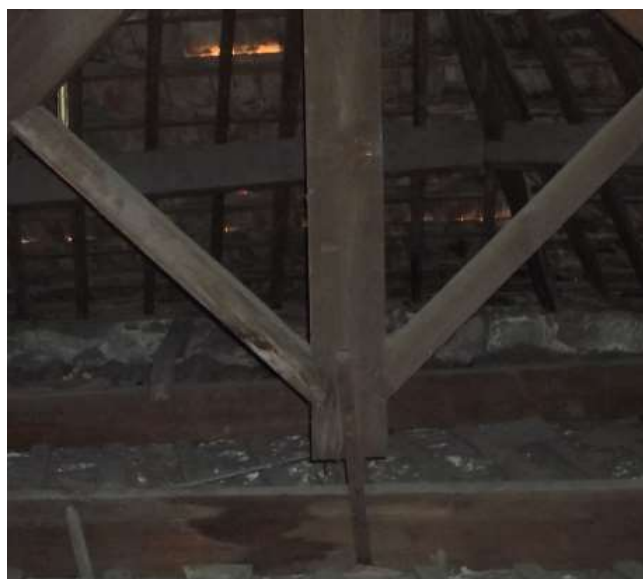
Figura 4.11.: O Ligador metálico entre o pendural e a linha da asna está desalinhado/desaprumado
