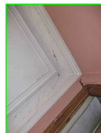
-3- Fissuração Parede / Teto
