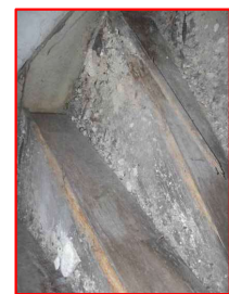
-1- Degraus Muito Degradados
