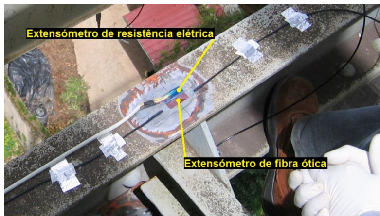
Figura 2.20 - Extensómetro de fibra ótica e resistência elétrica.
