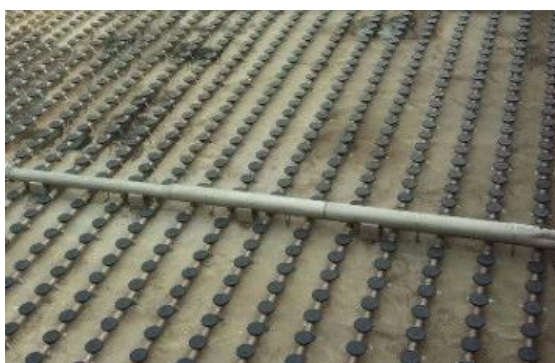
Figura 4.3. Difusores de bolha fina dispostos na superfície do reator.
