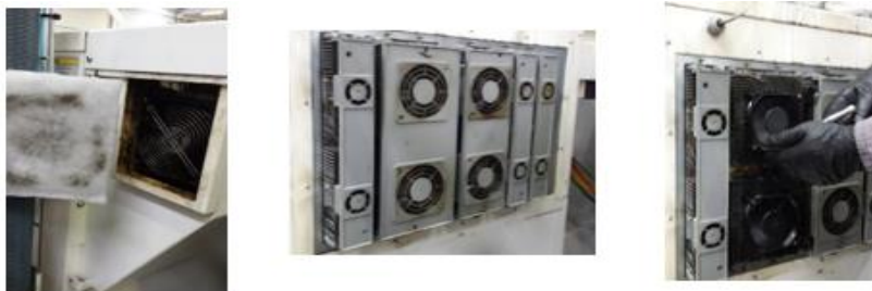
Figura 31 - Filtro de ar (Esquerda), Ventiladores (Centro), Limpeza dos ventiladores (direita)
