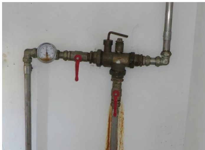
Figura 21 – Torneira Misturadora e Circuito
