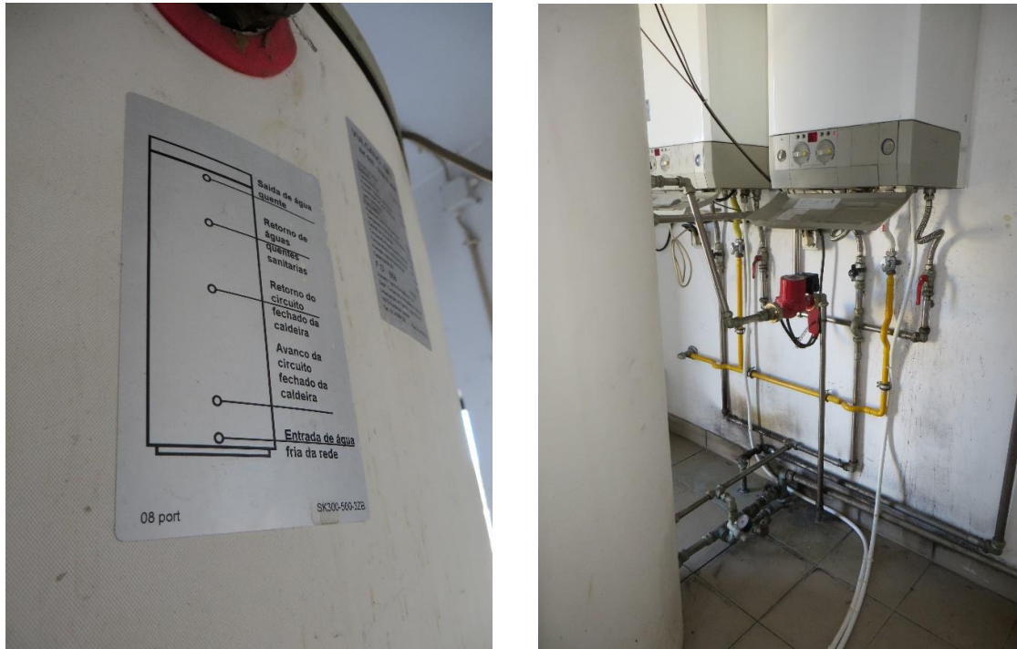
Figura 19 – Produção e Armazenamento de água quente
