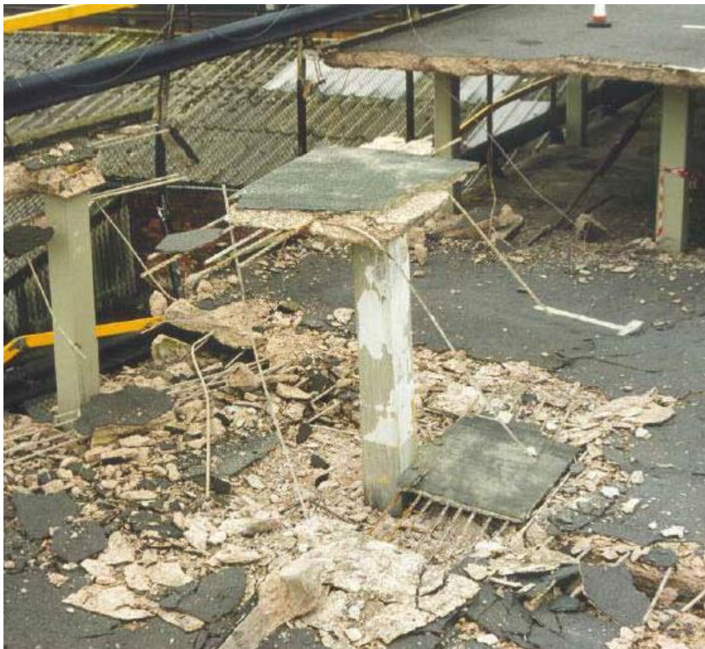
Figura 6 – Colapso em torno do pilar (Wood, 2002, p.7).
