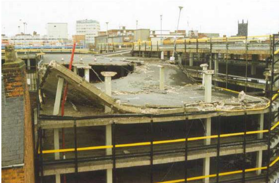
Figura 5 – Colapso parcial do 4.º piso de um parque de estacionamento em Wolverhampton , Reino Unido (Wood, 2002, p.7).
