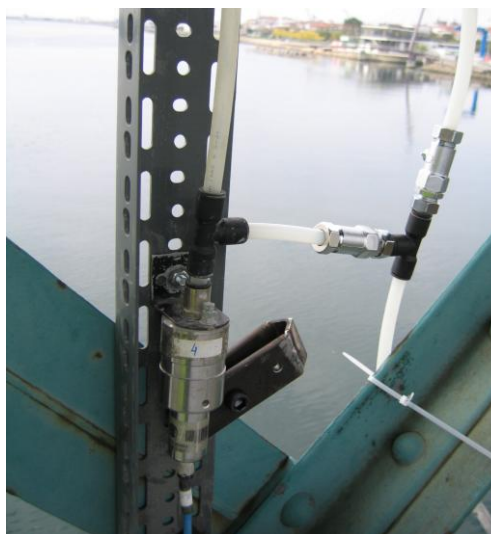
Figura 2.11 – Colocação em obra de sensor de pressão e seus acessórios.
