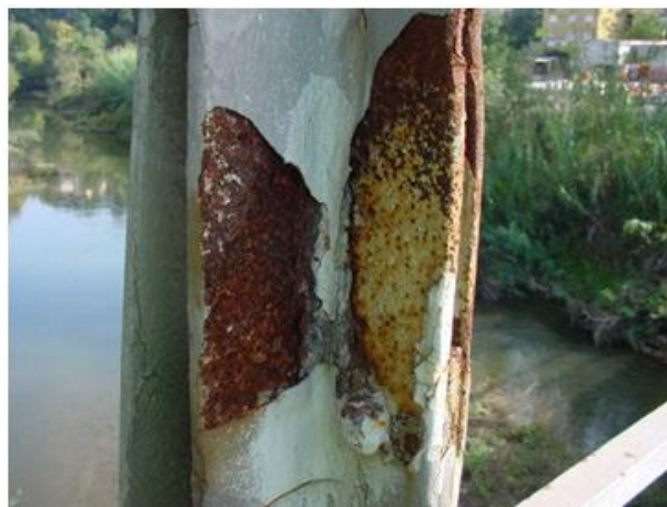
Figura 1.1 – Corrosão de elemento de estrutura metálica.
