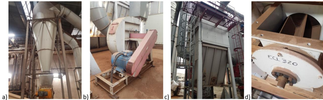
Figura 32 - Ciclone (a); ventilador (b); filtro (c); eclusa (d)
