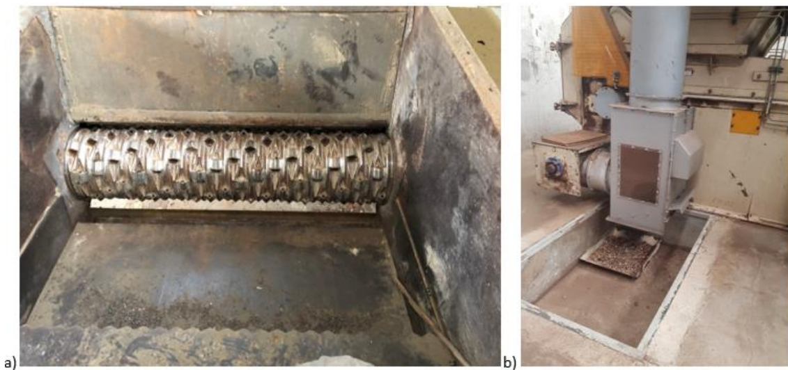
Figura 31 - Moinho destroçador (a); sistema de filtragem (b)
