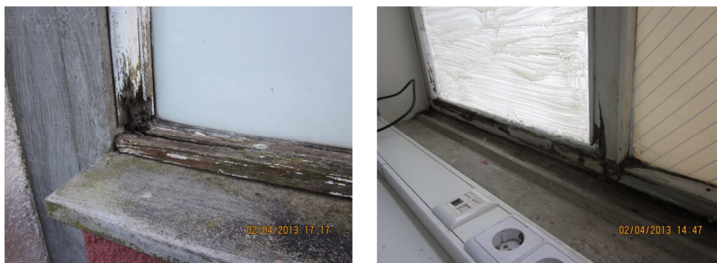
Figura 5.13: Caixilharia de madeira em elevado estado de deterioração junto à soleira, na escola ESAN.
