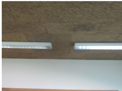
Figura 5.16: Presença de manchas de humidade no tecto da sala de aula da escola ESJA.
