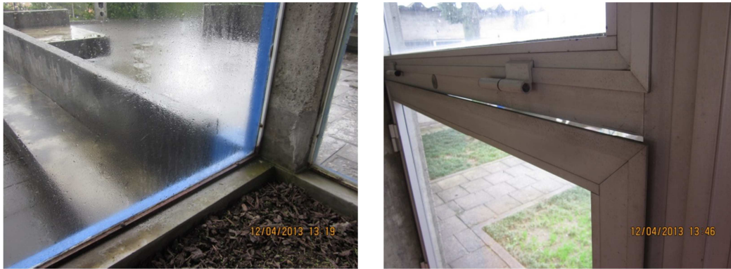
Figura 5.14: Ocorrência de condensações e existência frinchas nos vãos exteriores da escola EBSL.
