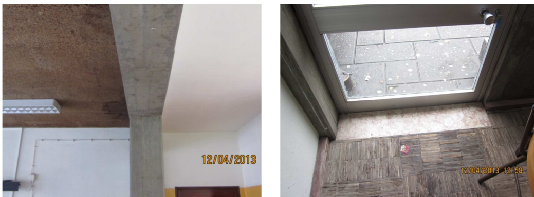
Figura 5.15: Infiltração de água no tecto e através da porta de acesso ao exterior, na sala de aula da escola EBSL.
