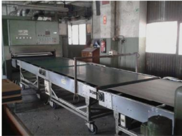
Figura 2.7 - Equipamento onde é efetuado o processo de serragem e lixagem
