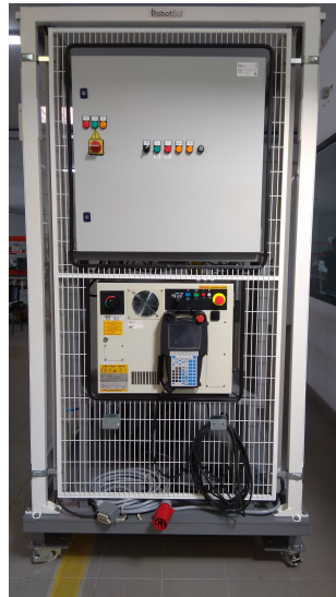
Figura 5.16: Quadro elétrico e controlador do robô instalados na estrutura
