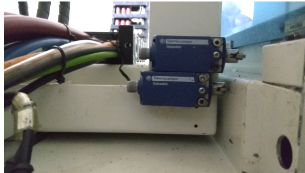
Figura 6.34: Interruptores de fim de curso da porta lateral da máquina de injeção
