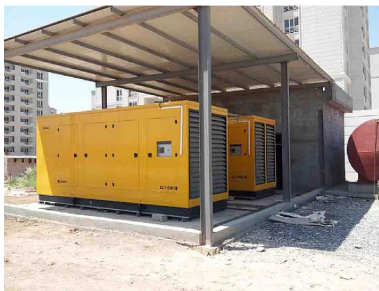
Figura 23 – Imagem de uma central elétrica a diesel (Fonte: Catpillar )
