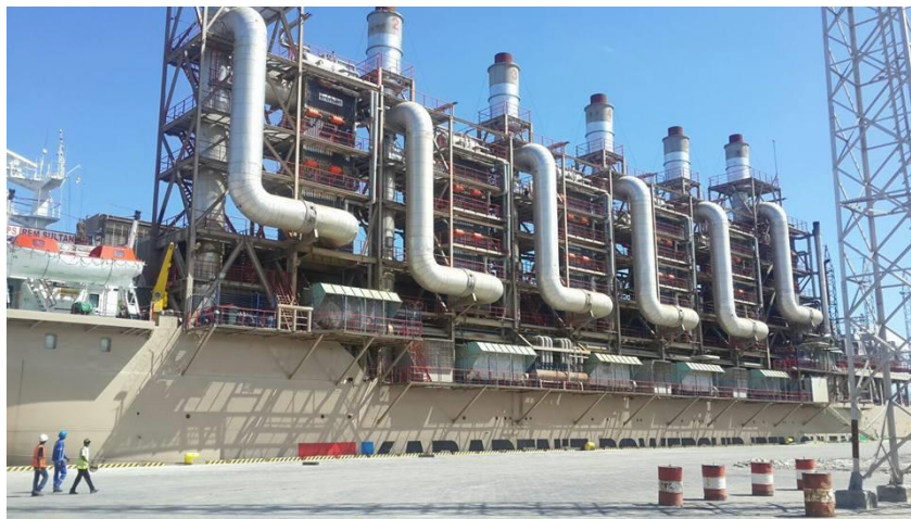
Figura 1 – Imagem da central térmica flutuante de Nacala (Fonte: EDM)
