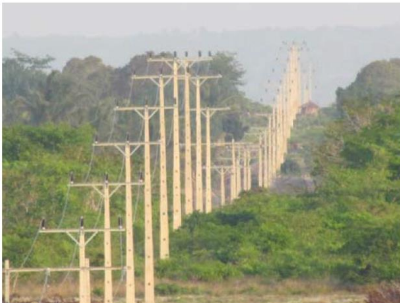
Figura 52– Imagem da linha de distribuição de energia elétrica de MT (Fonte: EDM).
