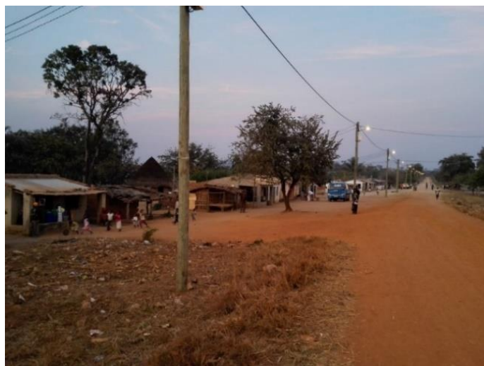
Figura 54– Imagem da rede de distribuição de energia de BT (Fonte:EDM)
