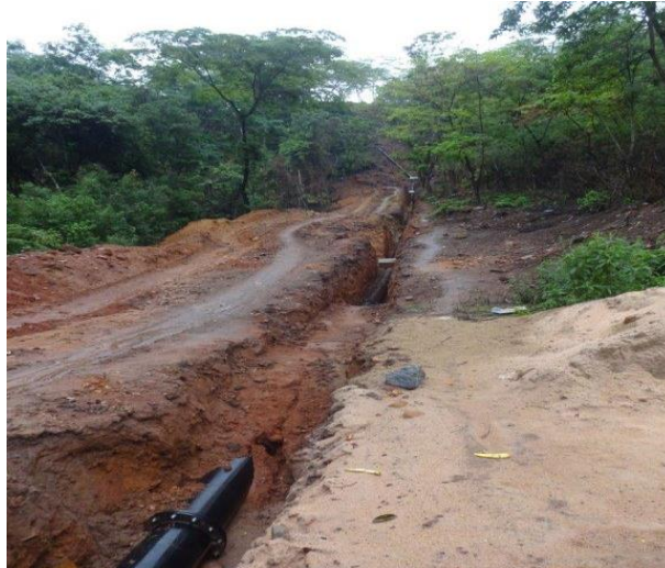
Figura 9 – Imagem da conduita forçada da CMH de Majaua (Fonte: FUNAE)
