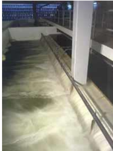
Figura 4.8 - Tanques de mistura de coagulante e floculante na água (www.addp.pt)
