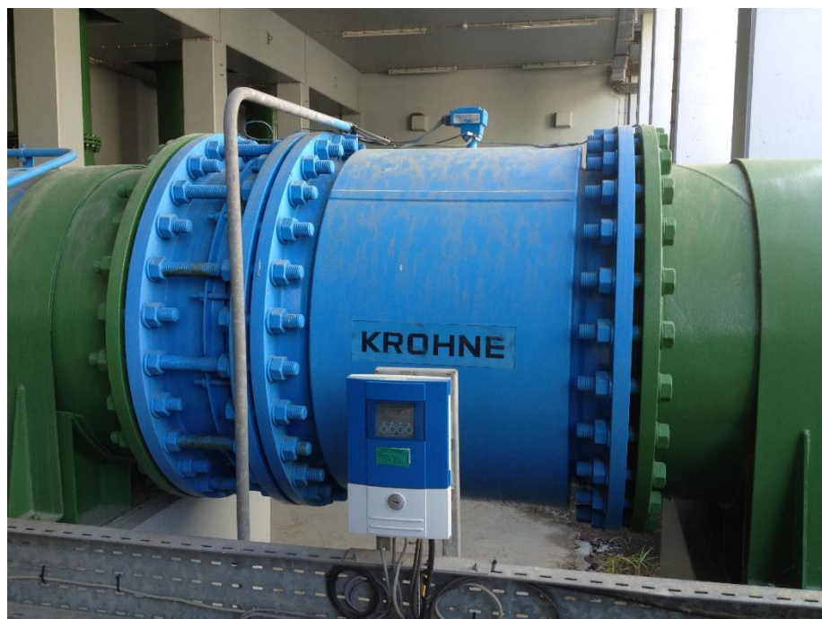
Figura 4.22 - Caudalímetro instalado à saída da ETA
