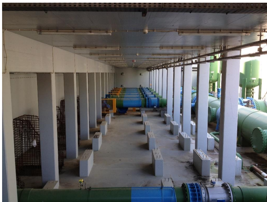
Figura 4.21 - Conduatas de saída da ETA
