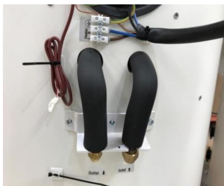
Figura 30 - Ligações elétricas efetuadas no termoacumulador
