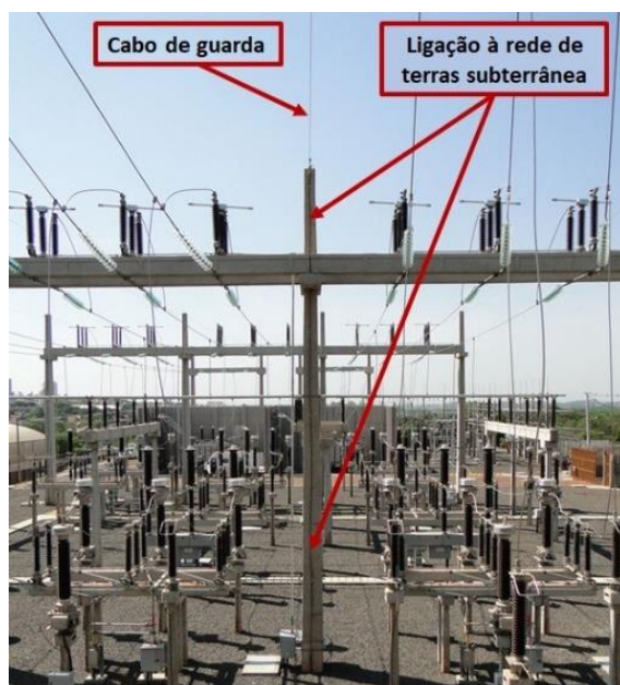
Figura 49 - Cabo de guarda apoiado no pórtico de apoio dos barramentos tendidos [30]
