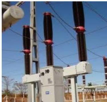
Figura 32 - Disjuntor de pequeno volume de óleo [23]
