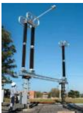
Figura 35 - Seccionador de abertura vertical [21]
