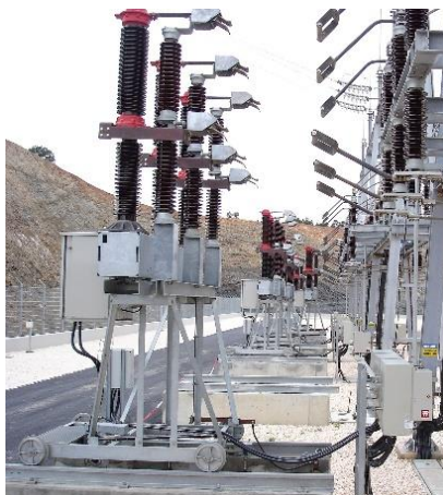
Figura 38 - Aparelho extraível (Subestação de Portimão 150/60kV)
