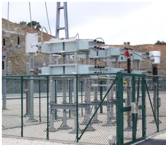
Figura 43 - Bateria de Condensadores (Subestação de Portimão 150/60kV)
