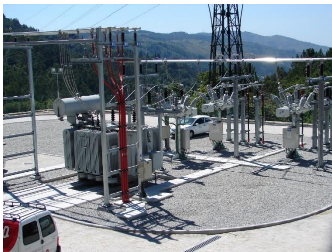
Figura 8 - Subestação Híbrida (Subestação da Caniçada 60/15kV)
