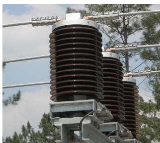
Figura 27 - Transformadores de Corrente (Subestação de Lijó 60/15kV)
