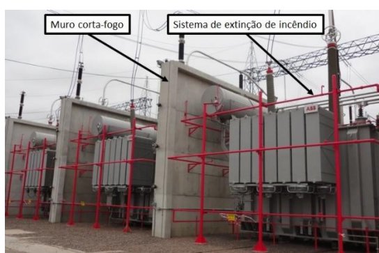
Figura 23 - Muro corta-fogo e sistema de extinção de incêndios
