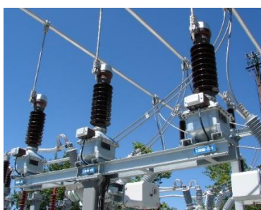
Figura 28 - Transformadores de Tensão (Subestação da Caniçada 60/15kV)
