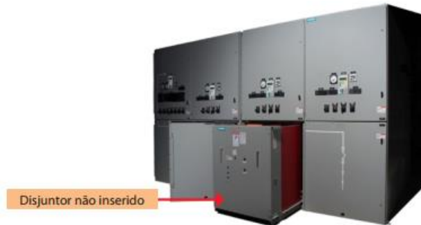
Figura 45 - Quadro de Média Tensão do tipo "Metal Clad" [26]
