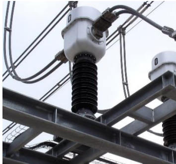
Figura 29 - Transformador de medida combinado (Subestação de Portimão 150/60kV)
