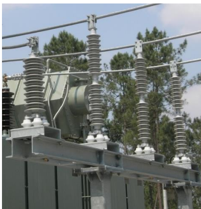
Figura 39 - Descarregador de sobretensões (Subestação de Lijó 60/15kV)
