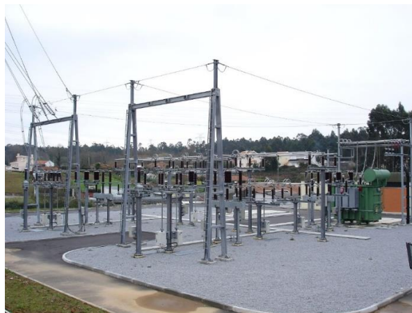
Figura 3 - Disposição de equipamento numa Subestação do tipo AIS (Subestação de Serzedo 60/15kV)
