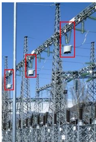
Figura 40 - Condensador de acoplamento e bobina tampão (Subestação de Panquehue 110/13,8kV)
