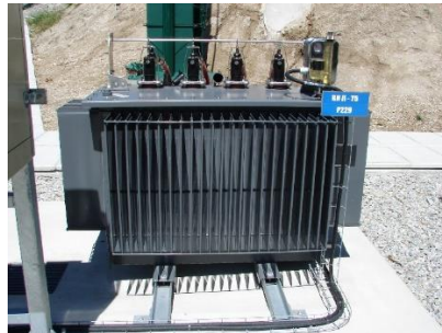
Figura 41 - Reatância de neutro (Subestação da Caniçada 60/15kV)
