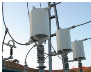
Figura 42 - Impedância limitadora de curto-circuito (Subestação de Portimão 150/60kV)
