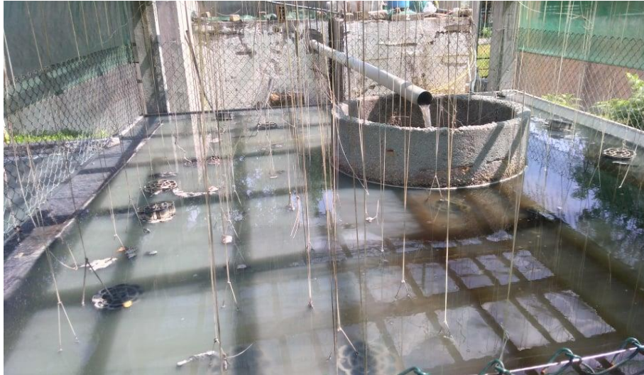
Figura 3.7 - Tanque de sedimentação.
