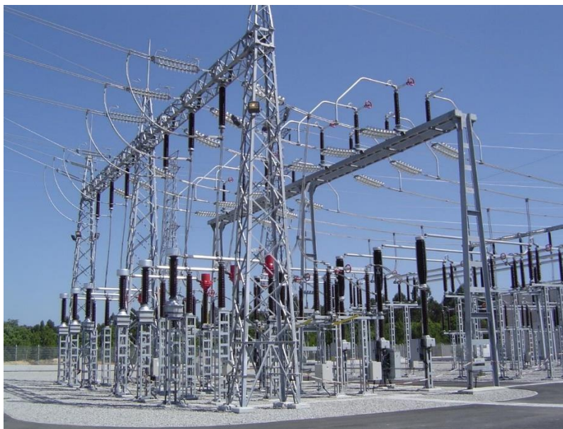
Figura 2 – Subestação de Alta Tensão.
