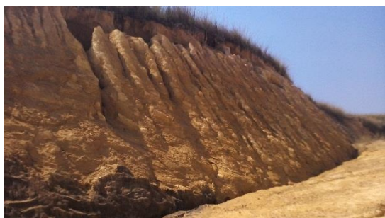
Figura 4.17 – Mau estado de taludes devido a inclinação acentuada e falta de proteção
