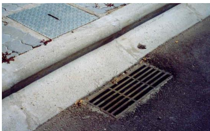
Figura 2.11 – Sumidouro junto a lancil em meio urbano (Neves, 2020)
