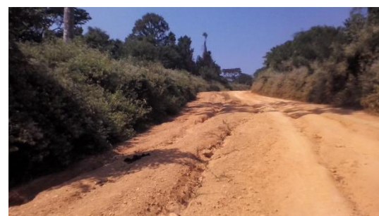
Figura 4.14 – Troço em terra batida marcas de escorrência de drenagem pluvial e invasão de vegetação
