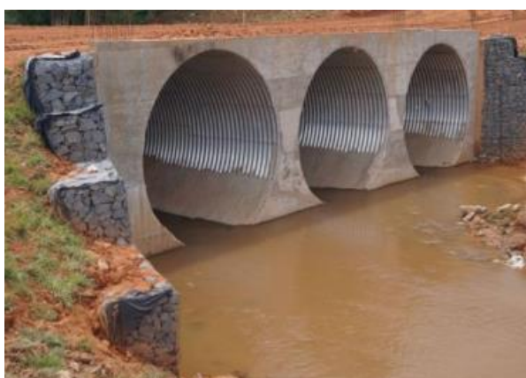
Figura 3.15 – Passagem hidráulica tripla em ARMCO (Jacob, 2018)
