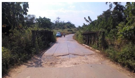
Figura 4.16 – Troço em betuminoso com peladas e fissuras
