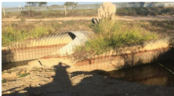
Figura 4.33 – Passagem hidráulica do tipo ARMCO (Victor Santiago, 2018)
