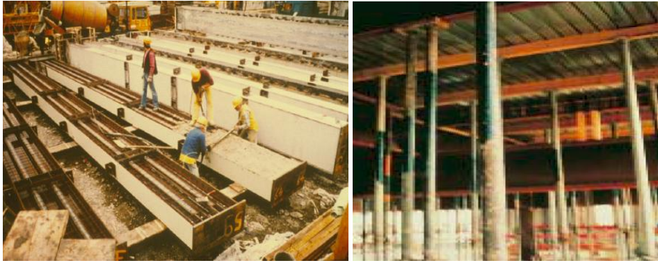
Figura 1.3 – Exemplos de construções em que os elementos metálicos assumem a função de cofragem.
