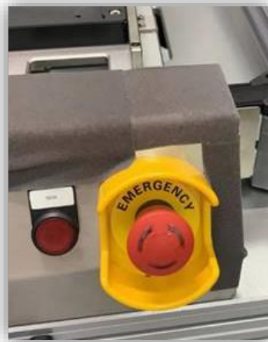
Figura 30 – Botoneira de Emergência com Proteção
