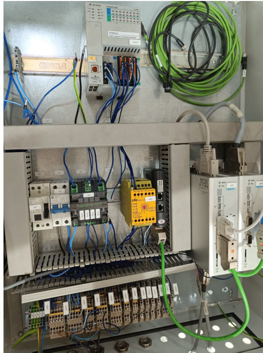
Figura 4.2: Estado do quadro antes da adaptação
