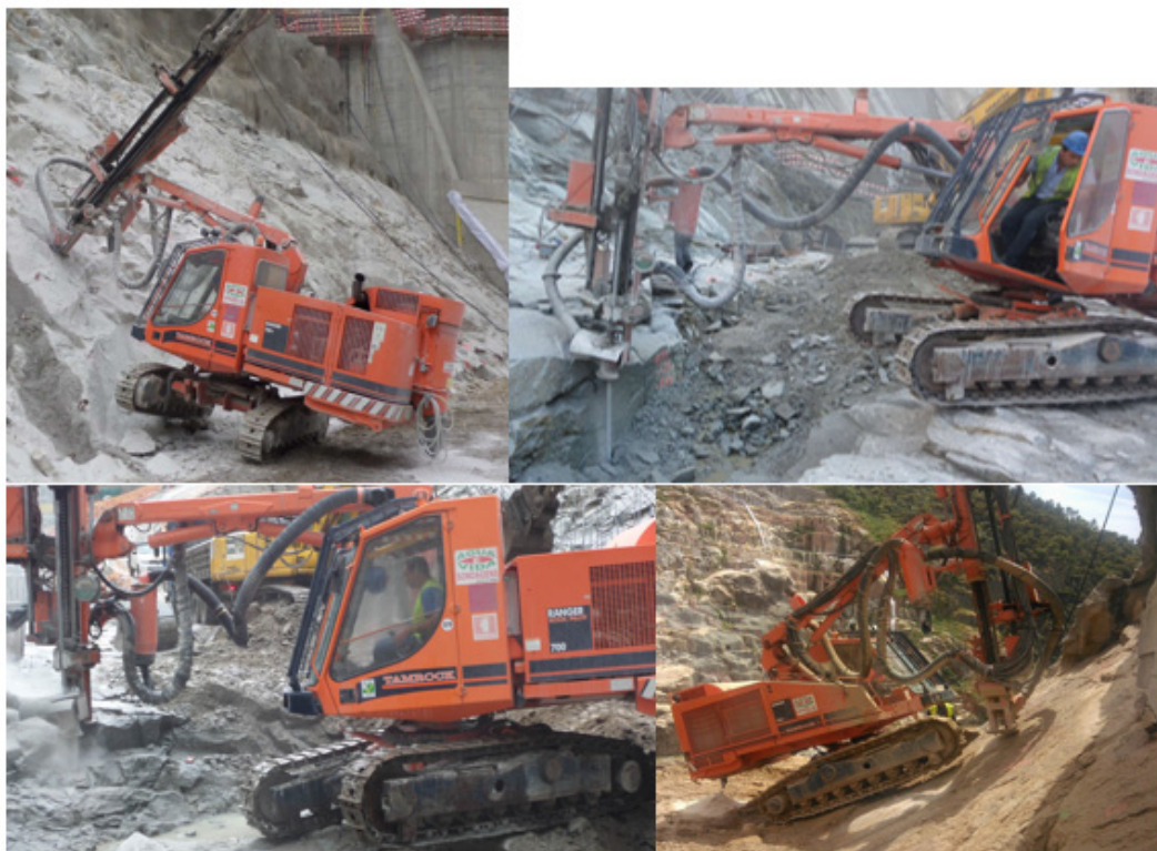
Figura 111. Posições de instabilidade verificadas durante a monitorização da perfuração.
