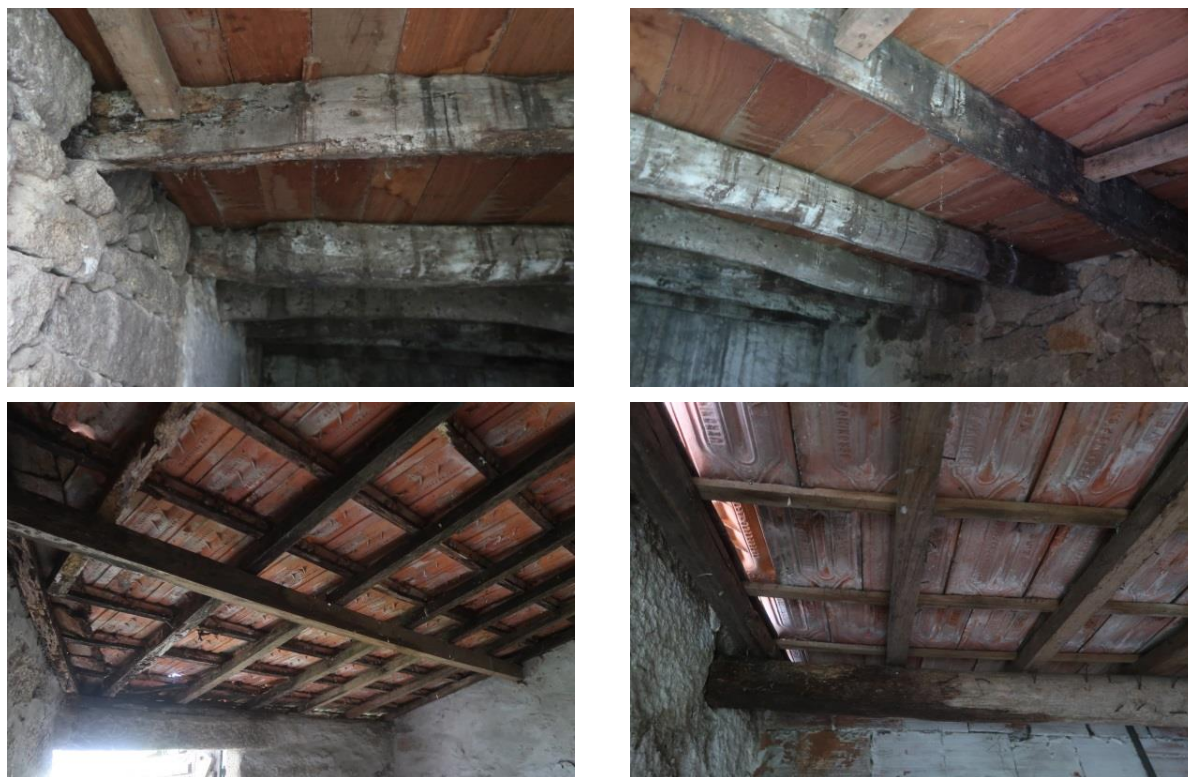
Figura 5.11 – Degradação das vigas de pavimento do piso 0 e das coberturas dos edifícios anexos
