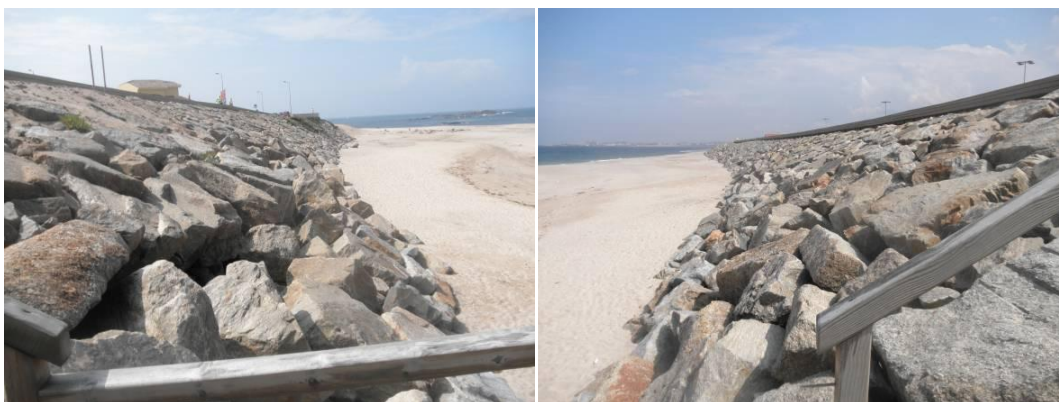
Vista Norte-Sul e Sul-Norte, evidenciando danos no talude do enrocamento
