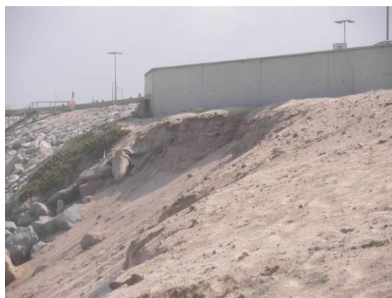
Erosão junto ao muro de betão
