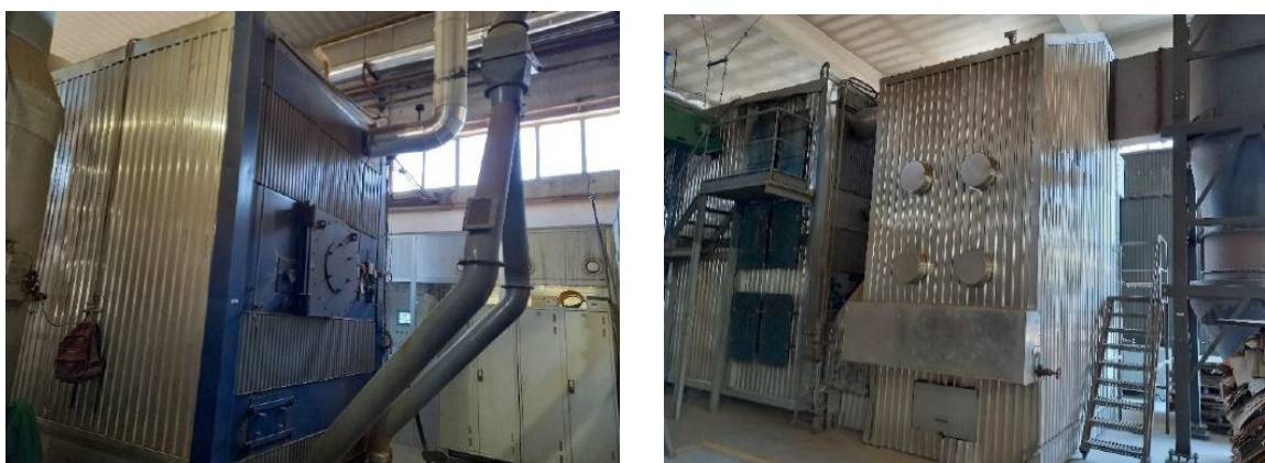
Figura 6 - Caldeira 1 (esquerda) e caldeira 2 (direita).
