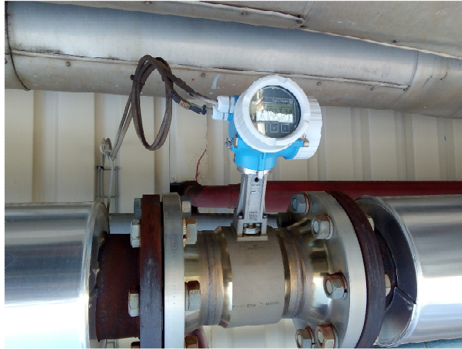
Figura 8 - Caudalímetros instalados ao longo da tubagem.
