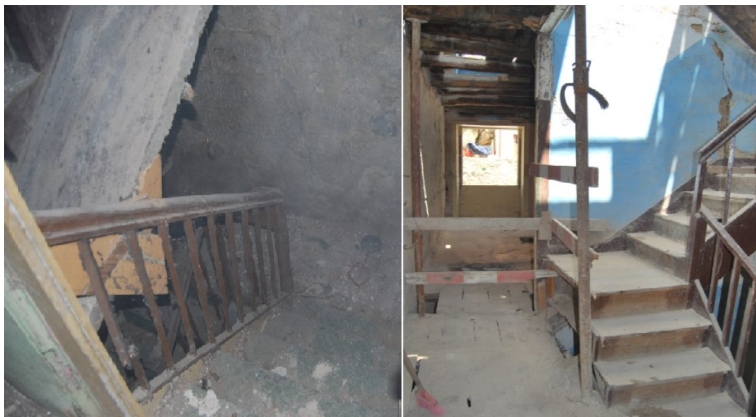
Figura 95 Interior da Parcela 26 - Escadas
