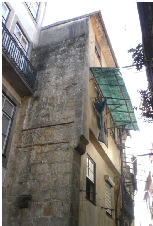
Figura 50 Fachada da operação F antes de qualquer intervenção - Fonte: Porto Vivo, SRU
