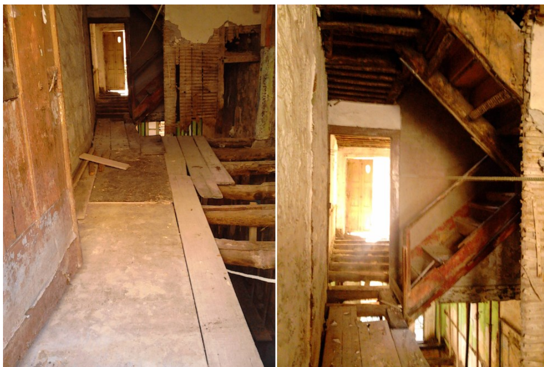
Figura 67 Pisos estreitos antes da aglutinação dos mesmos pela abertura na parede de meação (em granito) - Fonte: Porto Vivo, SRU
