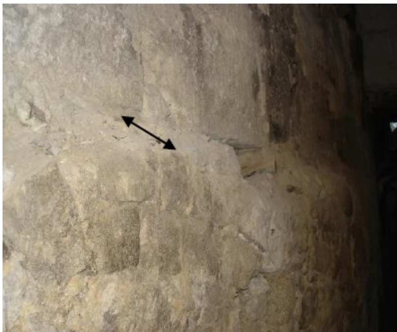
Figura 48 - Formação de uma "barriga" na parede do rés-do-chão - Fonte: Porto Vivo, SRU
