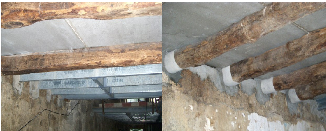
Figura 100 Vigas de madeira aproveitadas e de malha metálica sob o painel VIROC
