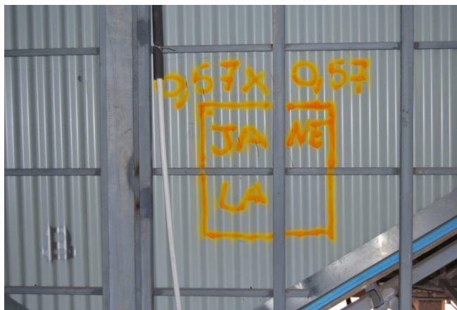
Figura 112 Nova janela proposta para a cozinha do último piso - Fonte: Porto Vivo, SRU
