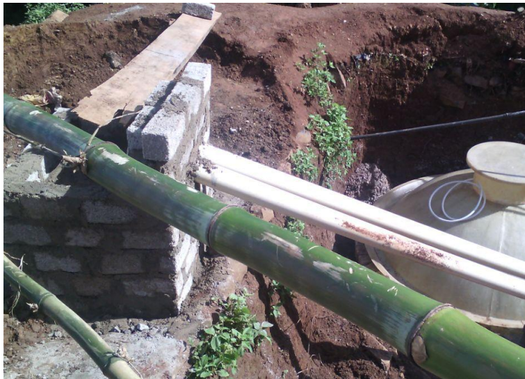
Figura 16 – Caixa de entrada. Fonte: Projeto Bio&Energy
