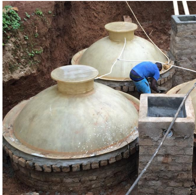
Figura 15 – Unidade de digestão anaeróbia com cúpula fabricada em fibra de vidro. Fonte: Projeto Bio&Energy
