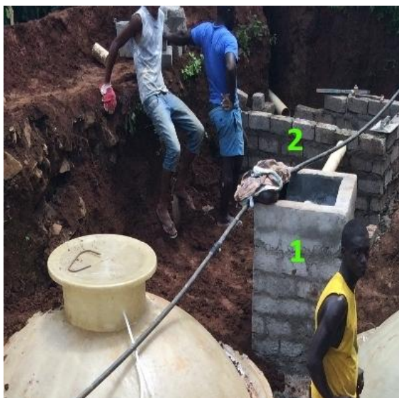
Figura 17 – Caixa de saída (1) e caixa de separação (2). Fonte: Projeto Bio&Energy
