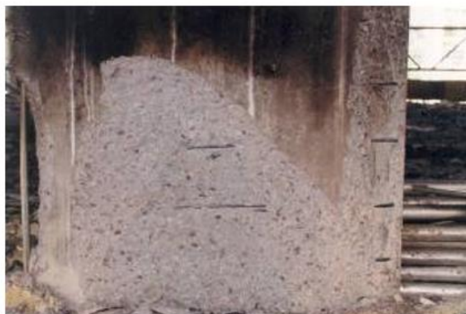
Figura 3.7 – Exemplo de spalling localizado (Concrete Society, 2008)
