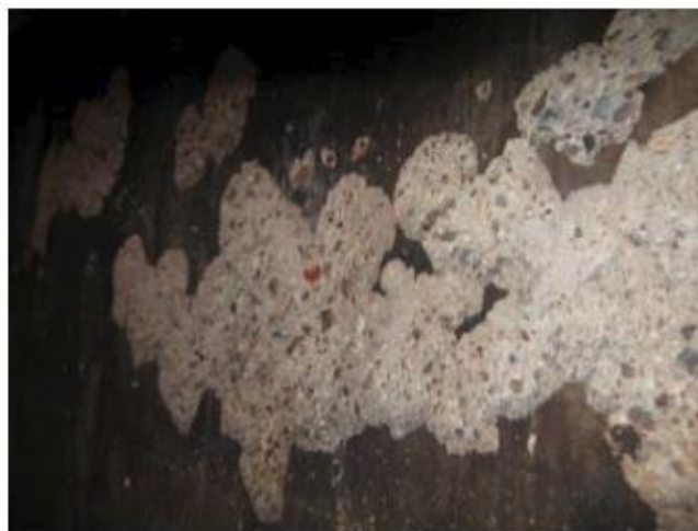
Figura 3.6 – Exemplo de spalling explosivo (Concrete Society, 2008)
