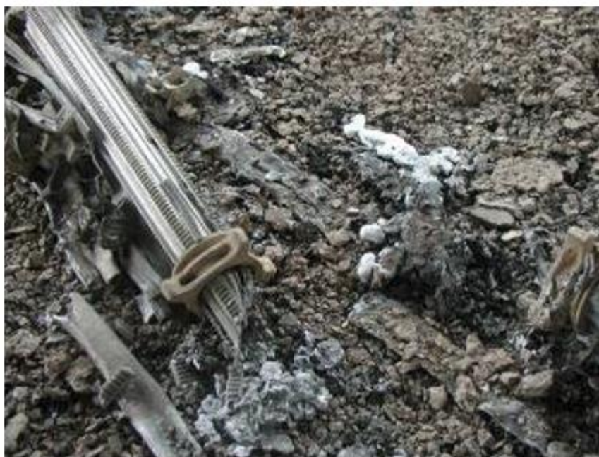
Figura 3.3 – Exemplo de fusão e formação de gotas de perfis de alumínio, indicadores de temperaturas acima de 650°C (Concrete Society, 2008)
