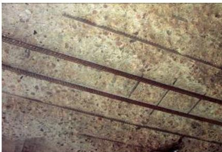
Figura 3.9 – Exemplo de deformação de armaduras (Concrete Society, 2008)
