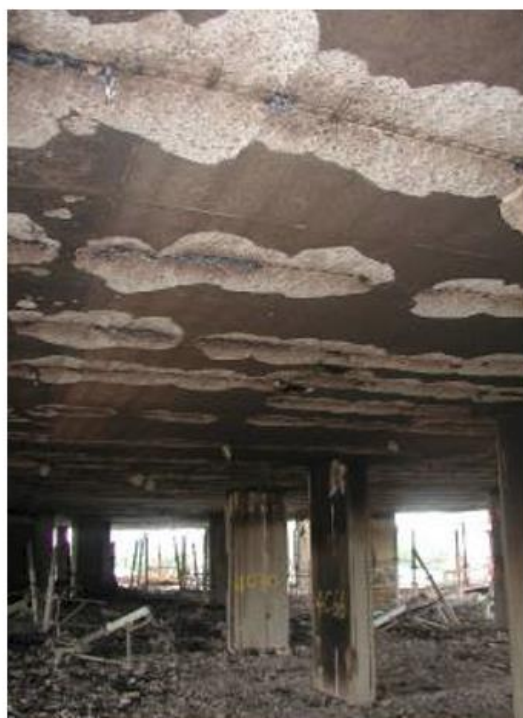
Figura 3.8 – Exemplo de spalling na face inferior de uma laje devido à deterioração por exposição a altas temperaturas de espaçadores em plástico (Concrete Society, 2008).
