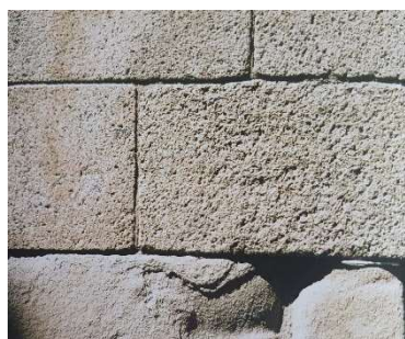
a) Pedra de granito afetada por desagregação granular e por alvéolos
