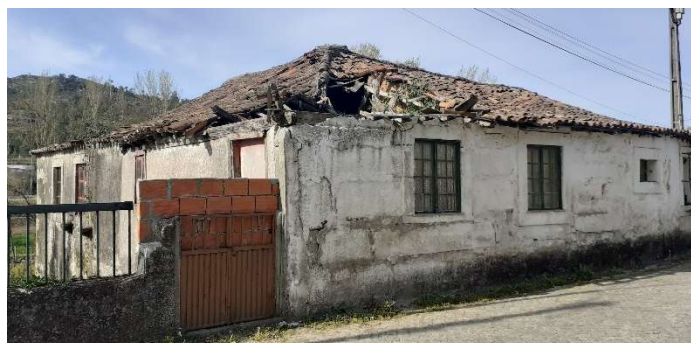
Figura 3.35 - Deterioração da cobertura do edifício.
