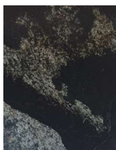
(e) Pedra de granito afetada por crostas negras
