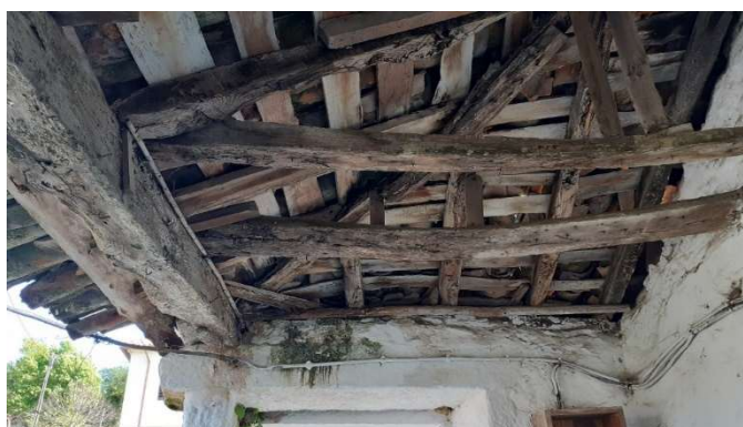
Figura 3.36 - Deformação (fluência) e deterioração dos elementos de madeira da cobertura do alpendre.
