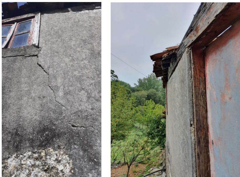
a) Fissura estrutural.
