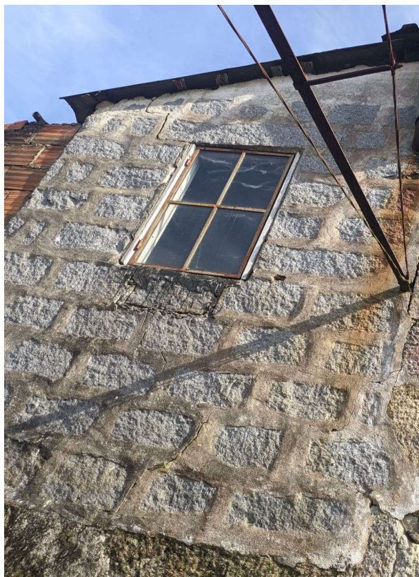
Figura 2 - Fissuras e colonização biológica no alçado posterior em cantaria de pedra.
