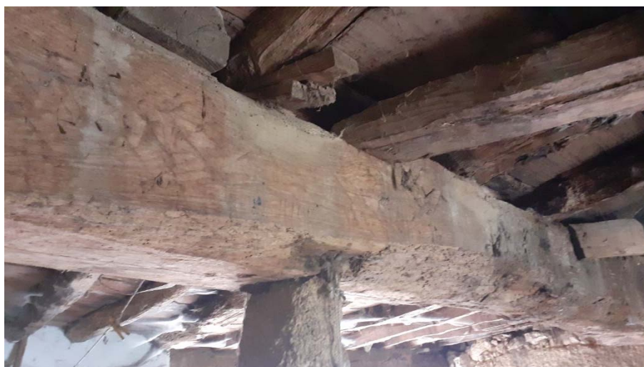
Figura 1 – Deterioração da viga 1.3 – teto do rés-do-chão.
