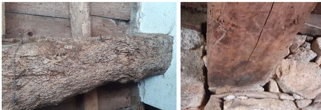
a) Deterioração da viga por ataque de insetos xilófagos.
