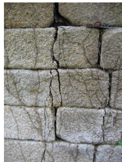
c) Fratura de pedras de um arco [Fratura de pedras na segunda fiada do arco - IC (up.pt)]
