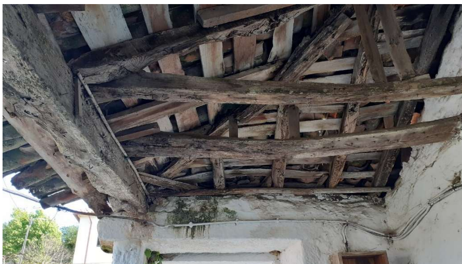
Figura 1 - Deformação da estrutura em madeira da cobertura - apendrece a noroeste do edifício.
