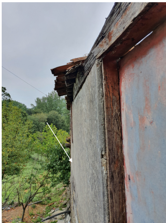
Figura 3 - Deformação para fora do plano – fachada a sudoeste do edifício.
