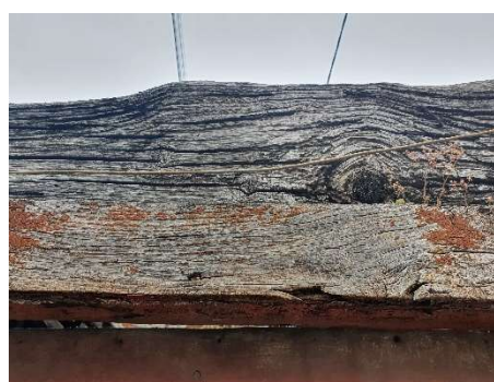
Figura 2.19 – Desfibramento superficial da madeira por ação do sol (foto cedida pela Dr. Building).
