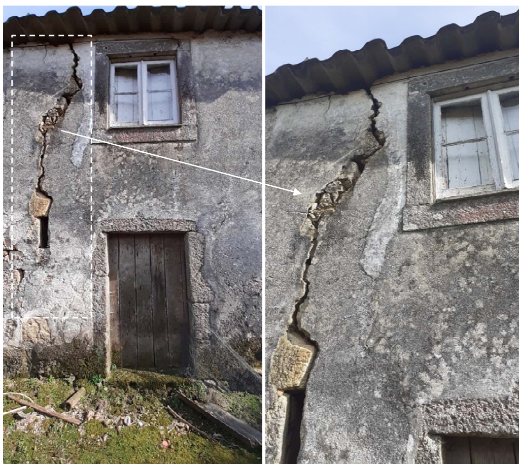
Figura 1 – Fissura das juntas - fachada a noroeste do edifício
