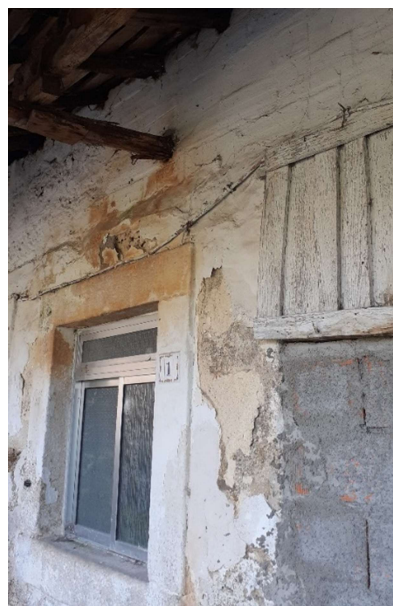
Figura 2 - Destacamento do revestimento da parede do alçado lateral direito.
