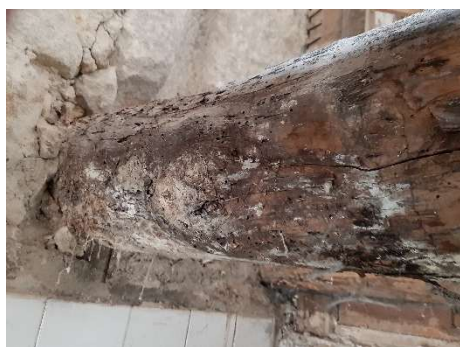
Figura 2.20- Existência de fungos de podridão branca ou fibrosa (cedida pela Dr. Building).
