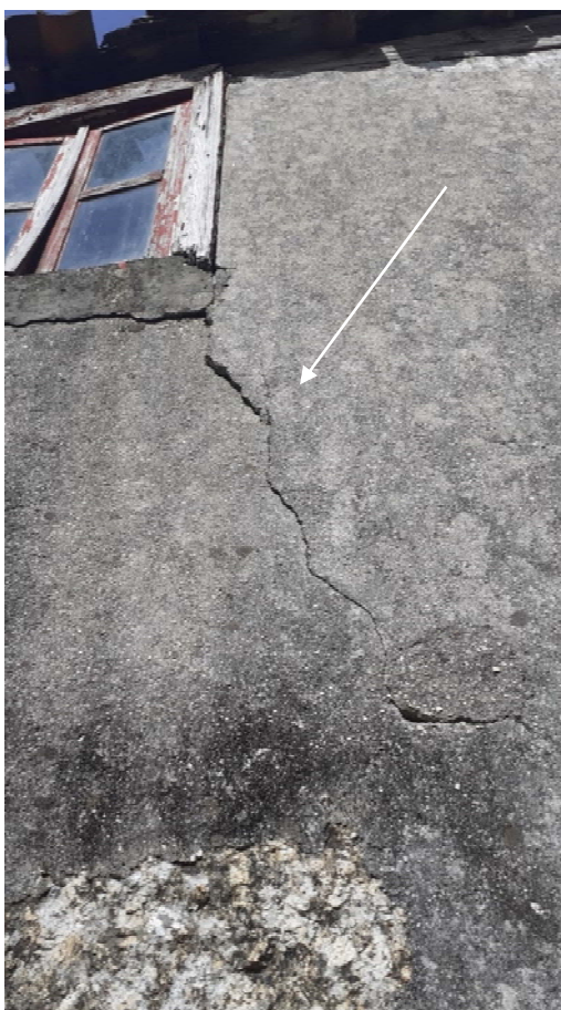
Figura 1 – Fissura diagonal - fachada a sudoeste do edifício.
