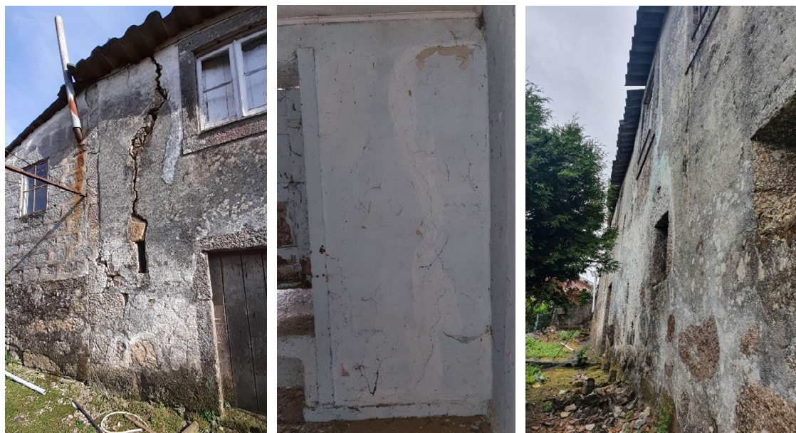
a) Fenda entre elementos de alvenaria de pedra (face exterior).
