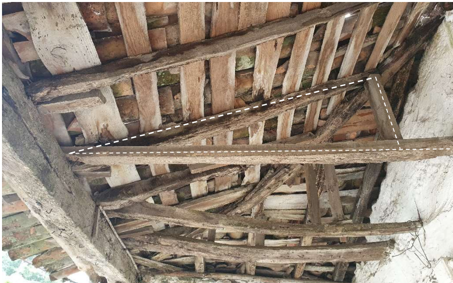
Figura 1 - Deterioração/deformação da meia asna de madeira - alpendre a nordeste do edifício.
