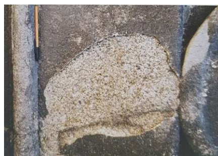
b) Cicatriz de placa em pedra de granito
