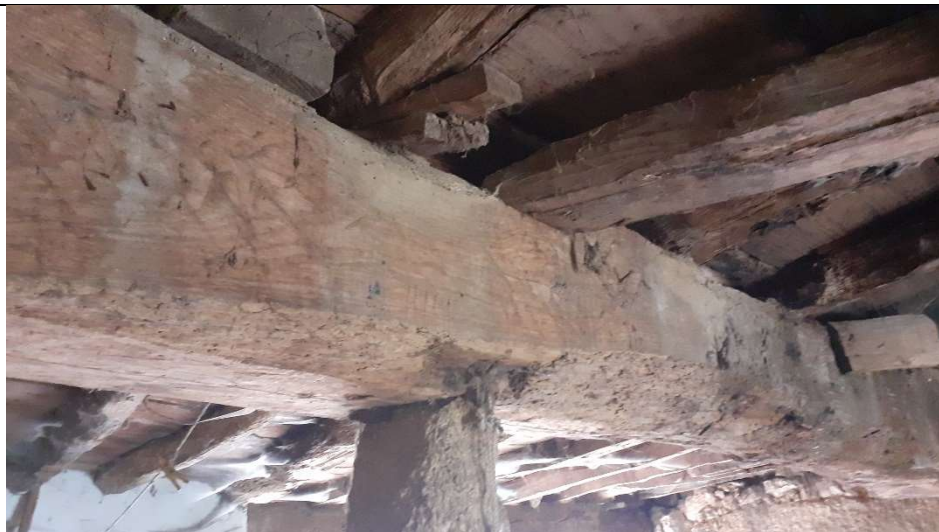
Fotografia 3 – Viga com perda de secção, evidenciando o ataque de insetos xilófagos.
