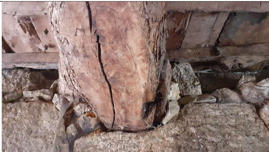
Fotografia 1 – Encontro da viga com a parede de alvenaria, evidenciando uma fenda longitudinal, nós e ataque de insetos xilófagos.
