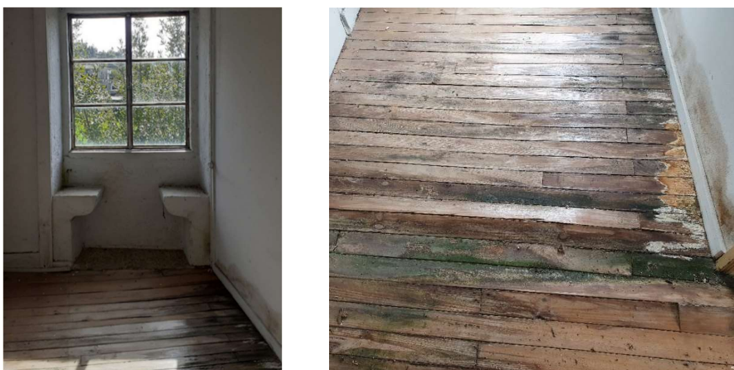
a) Deformação e deterioração do soalho em madeira.
