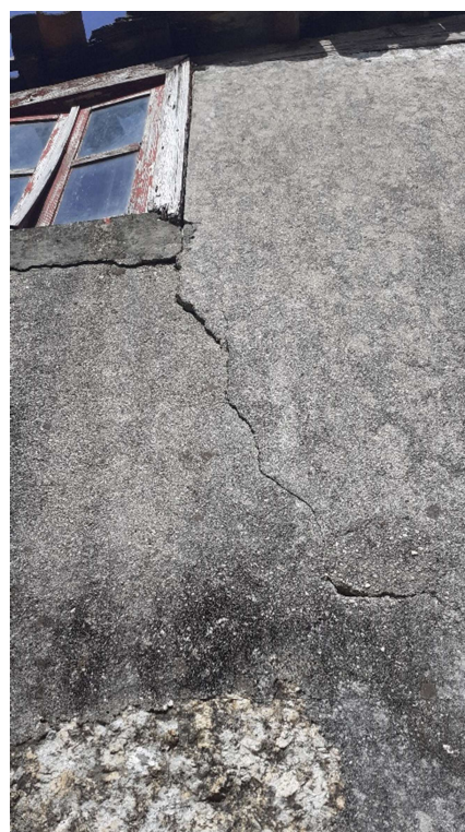
Figura 3 - Fissura diagonal verificada no alçado lateral esquerdo.
