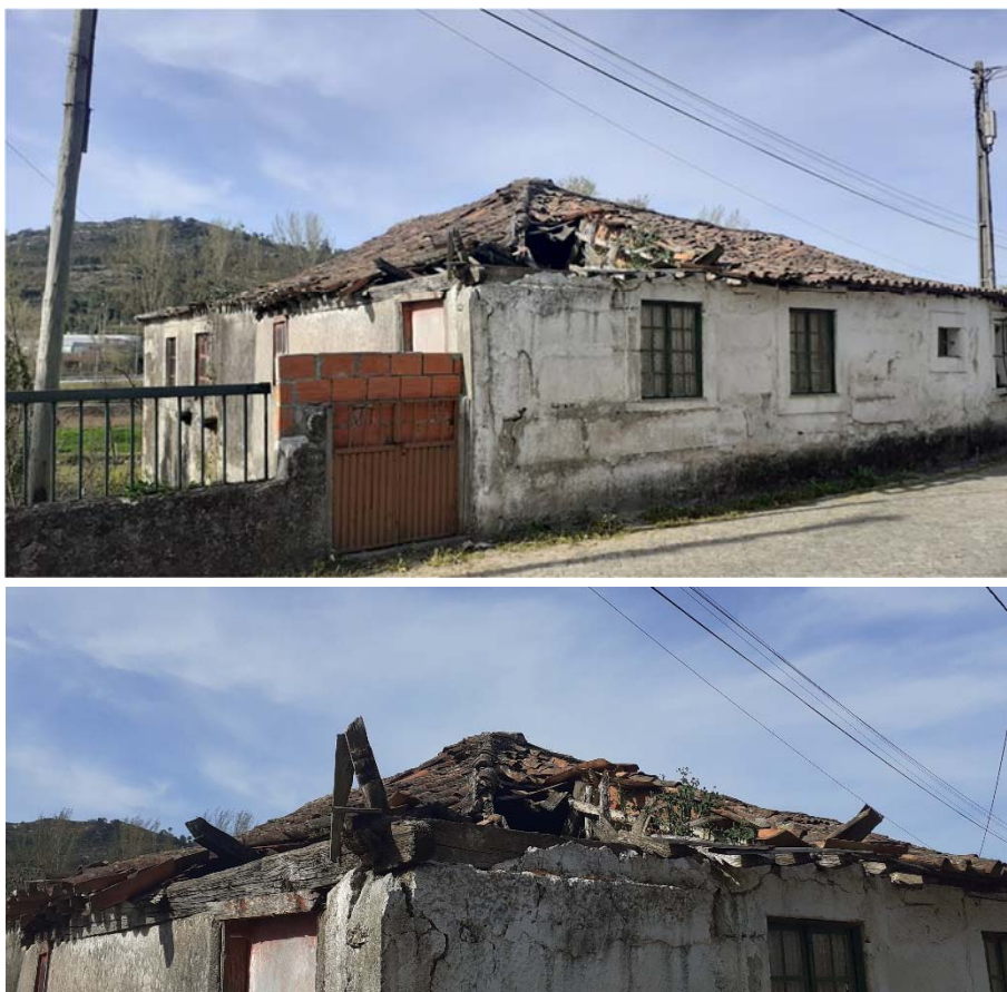
Figura 1 - Deterioração da cobertura - vista do arruamento.
