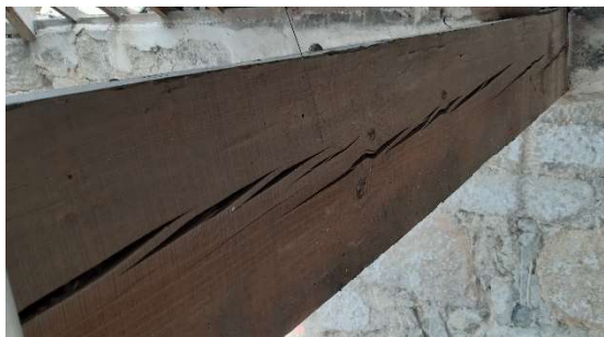
Figura 2.23 - Defeitos em elementos de uma cobertura (fendas de secagem e presença de nós, respetivamente da esquerda para a direita) (fotos cedidas pela Dr. Building).
