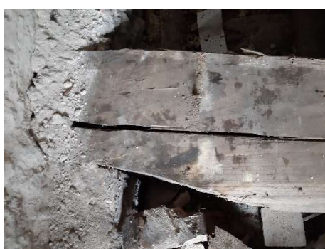
Figura 2.18 - Presença de manchas de humidade e fenda no encontro da viga com a parede exterior (foto cedida pela Dr. Building).
