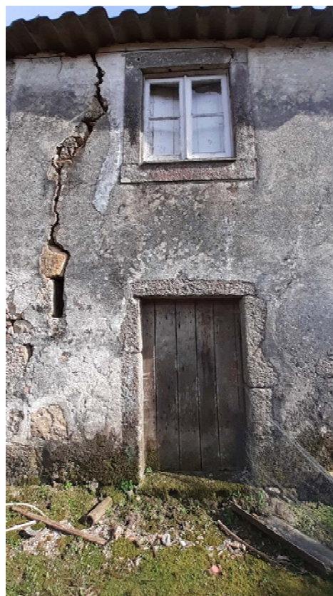
Figura 2 - Alçado posterior em alvenaria de pedra, evidenciando a fenda principal.
