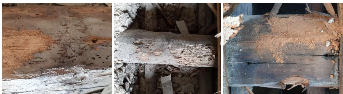
Figura 2.22 - Ataque de insetos xilófagos (fotos cedidas pela Dr. Building)
