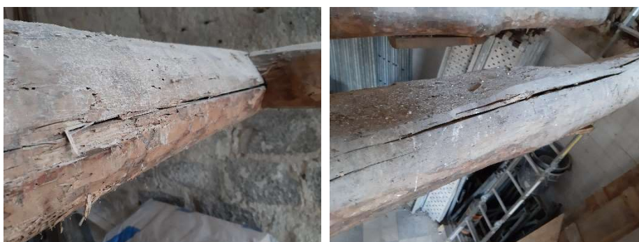
Figura 2.17- Existência de fendas de secagem em vigas de pavimento (fotos cedidas pela Dr. Building).
