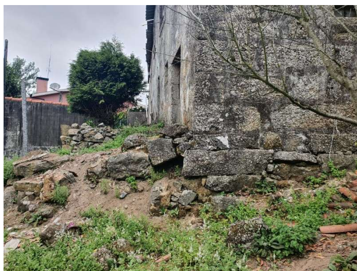
Figura 3.34 - Descalçamento das fundações.
