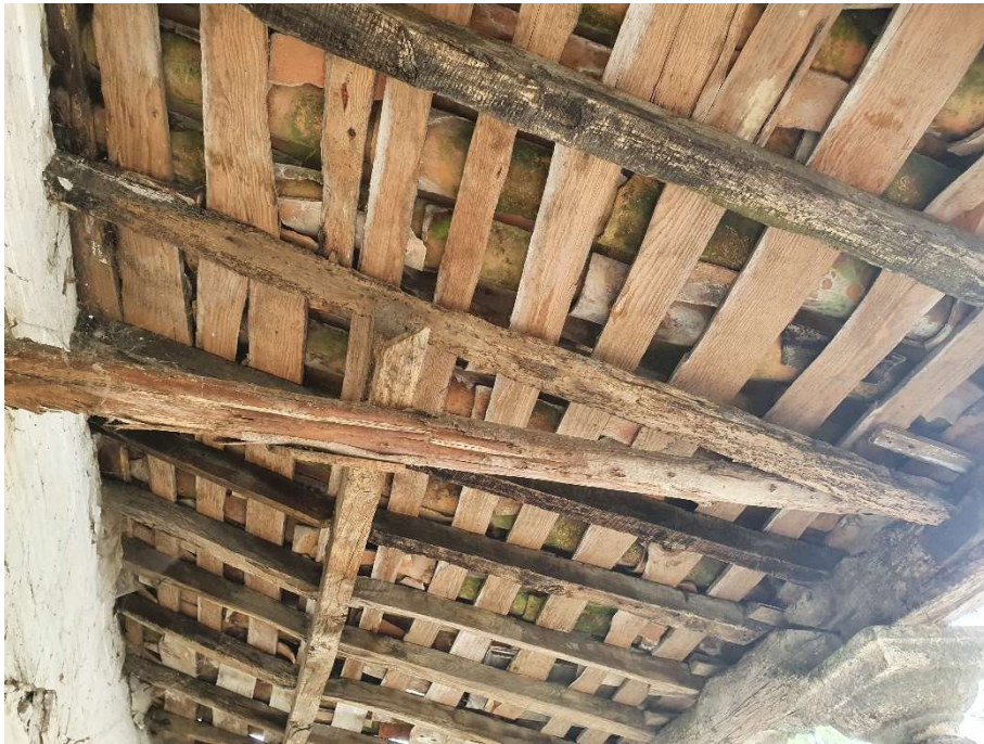
Figura 2 - Deterioração da estrutura em madeira da cobertura – alpendre a nordeste do edifício.
