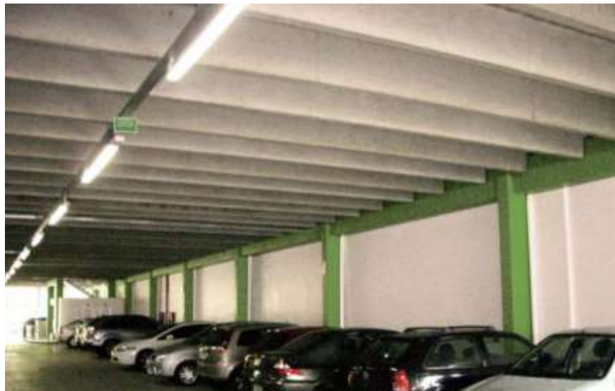
Figura 22 - Lajes Duplo T – Parque de estacionamento.
