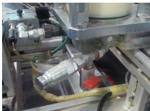
Figura 56 - Válvula de enchimento do reservatório
