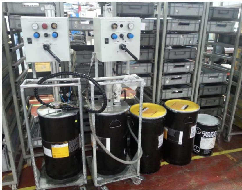
Figura 45 - Local de armazenamento dos sistemas de enchimento móveis
