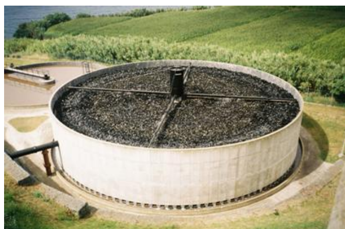
Figura 5.17 - Leito Percolador (C.M. Angra do Heroísmo, 2009)
