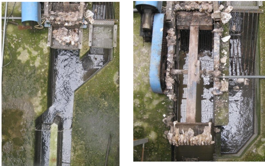
Figura 7.15 - Grelha de limpeza automática da ETAR do Centro Histórico de Rates
