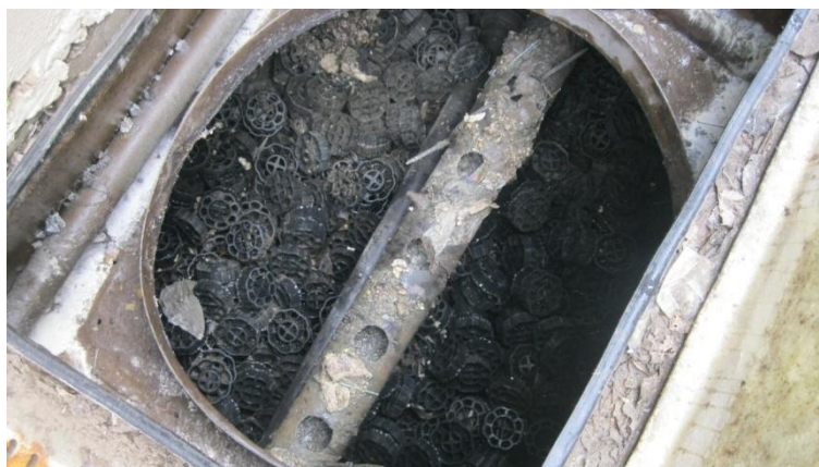
Figura 7.10 - Compartimento correspondente ao leito percolador da ETAR da Incondave
