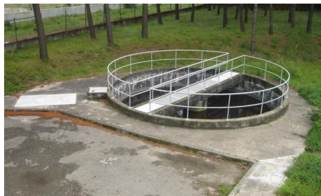
Figura 7.7 - Tanque de decantação secundária da ETAR do parque industrial de Laúndos
