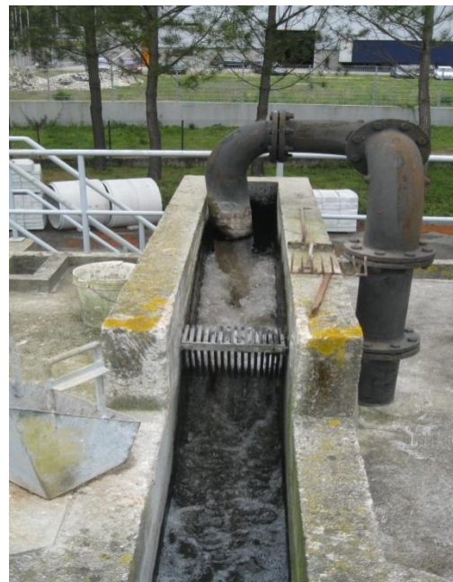
Figura 7.4 - Gradagem da água residual à saída da estação elevatória da ETAR do parque industrial de Laúndos
