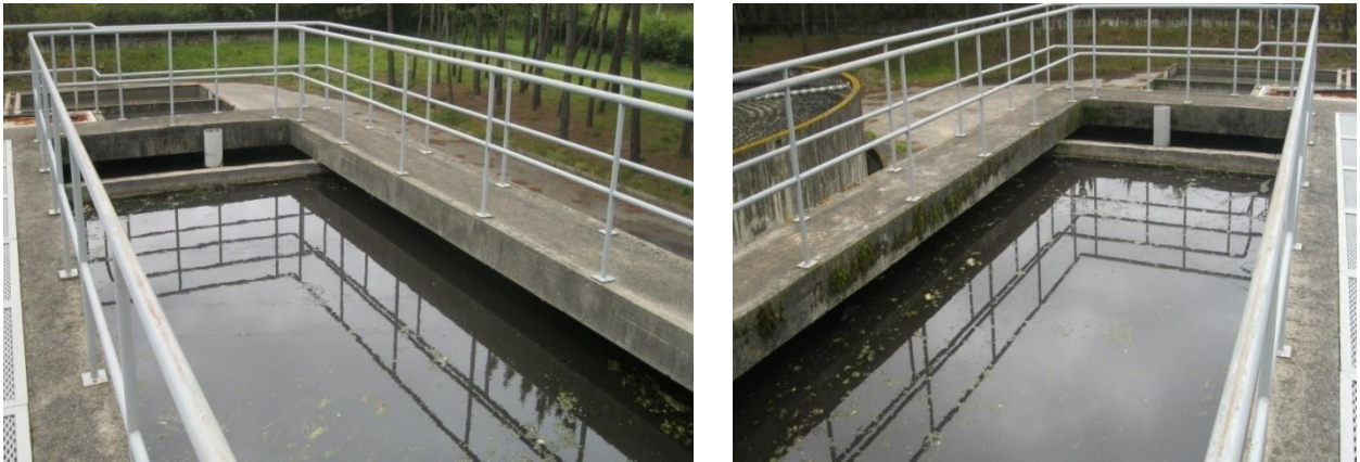
Figura 7.5 - Tanques Imhoff da ETAR do parque industrial de Laúndos
