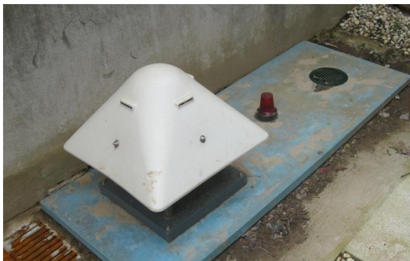
Figura 7.11 - Chaminé de entrada de ar para ventilação da ETAR da Incondave
