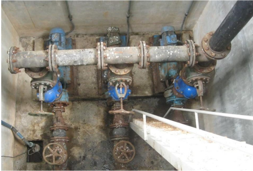
Figura 7.2 - Bombas responsáveis pela elevação das águas residuais da ETAR do parque industrial de Laúndos
