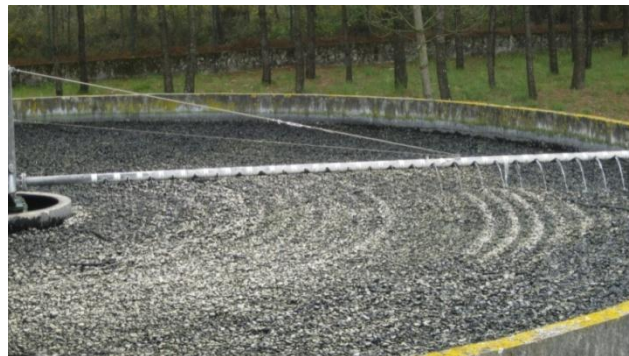
Figura 7.6 - Leito percolador da ETAR do parque industrial de Laúndos
