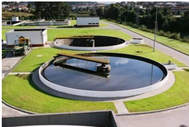
Figura 5.15 - Vista geral de um decantador secundário (Veolia, 2007)
