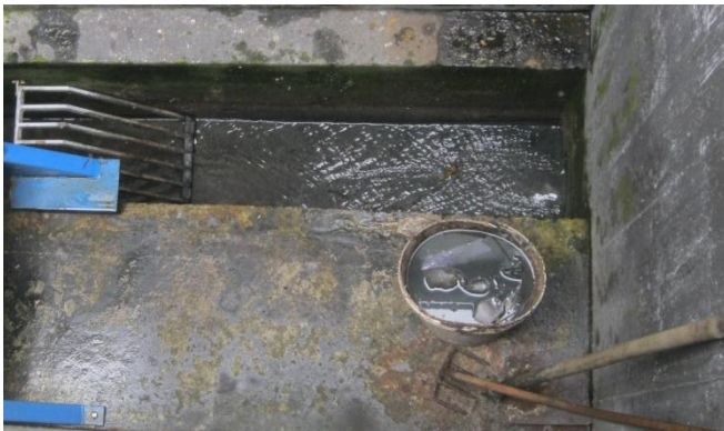
Figura 7.3 - Gradagem da água residual à entrada da estação elevatória da ETAR do parque industrial de Laúndos
