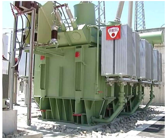
Figura 1 – Transformador de potência
