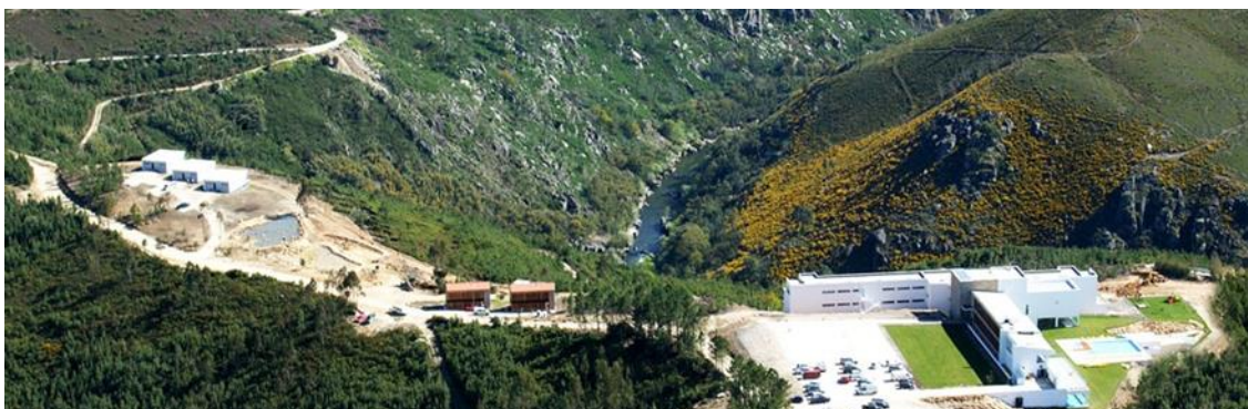
Figura 2. Vista aérea do Hotel Águahotels Mondim de Basto, ainda na fase de obra.
