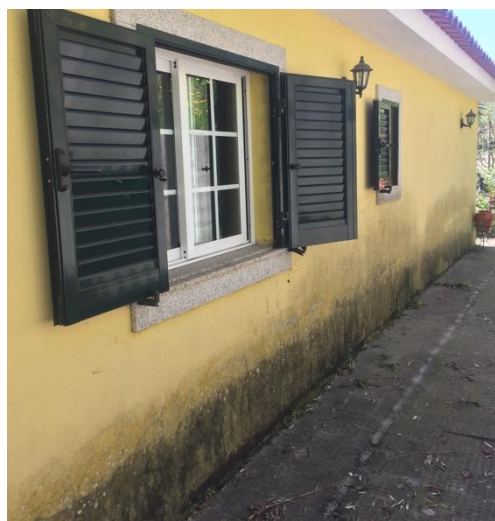
a) Eflorescentes existentes no suporte .
