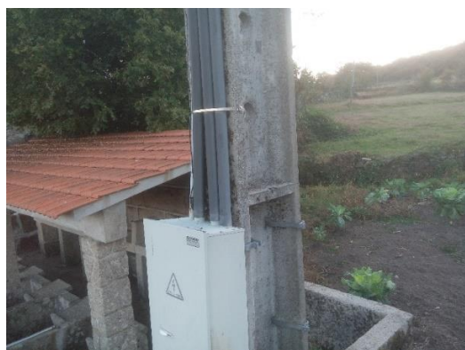
Figura 15 – Quadro Geral de Baixa Tensão do posto de transformação de Lamas
