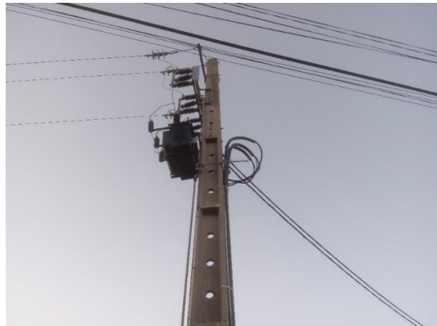
Figura 14 – Transformador do posto de transformação de Lamas
