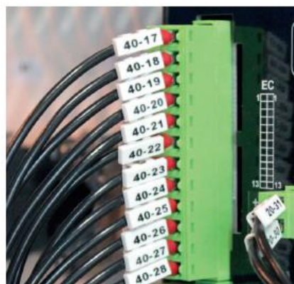
Figura 48 - Identificação dos cabos através de numeração numérica
