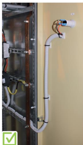
Figura 41 - Cablagem protegida por uma manga de plástico
