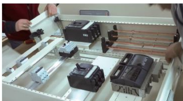
Figura 19 - Boas práticas para montagem do quadro elétrico
