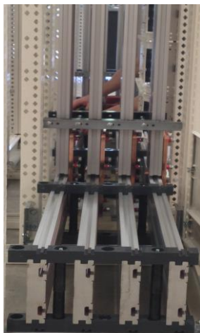
Figura 11 - Suporte dos barramentos
