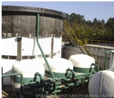
Figura 2.7 – Imagem do decantador e dos filtros da ETA
