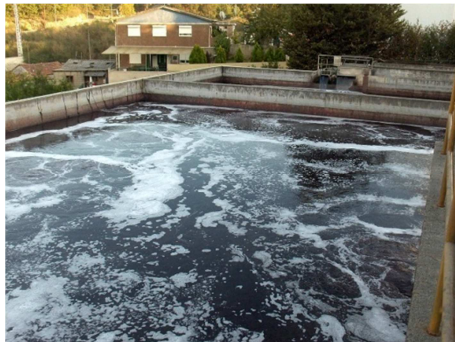
Figura 2.8 – Imagem do tanque de equalização 1 da EPTAR
