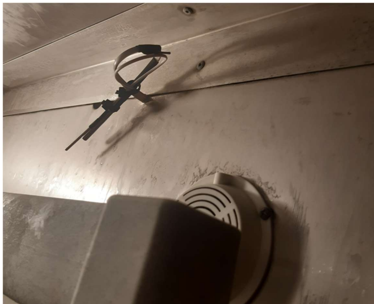
Figura 13 – Sonda de um sensor ELTEK que mede a temperatura e Humidade Relativa, pertencendo à Cozinha do HML. Este mede as condições ambientais de uma arca frigorífica ou congeladora.
