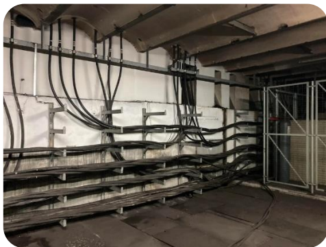
Figura 1 - Cablagem subterrânea numa subestação Convencional (Fonte: Autor desconhecido).
