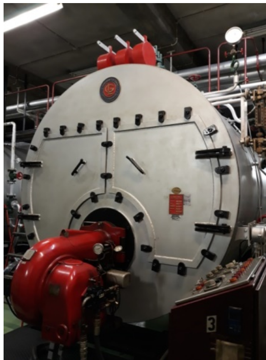
Figura 9 – Imagem de caldeira a gás de vapor tipo edifício A
