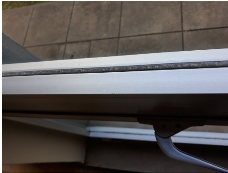
Figura 7 – Imagem de vidro simples e caixilharia alumínio de janela tipo edifício A
