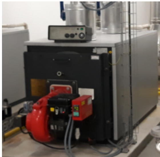
Figura 11 – Imagem de caldeira gás tipo edifício B
