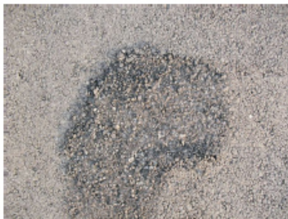
Figura 4.11 – Vista do defeito da pista de aterragem e descolagem de Catoca (Latersolo, 2010)
