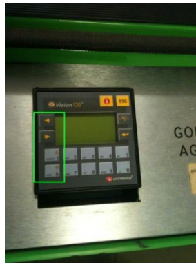
Figura 20 – Botões de controlo na consola do PLC V120
