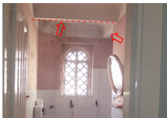
b) Vista geral da casa de banho do piso 1, com possível existência de elementos de betão armado (lajes e vigas) ao nível do piso 2
