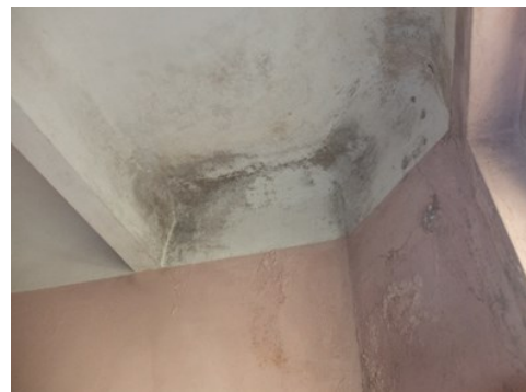
b) Mancha de humidade e presença de fungos no teto (zona de casa de banho do corpo posterior)
