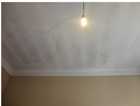
c) Presença de fissuração e manchas de humidade no teto do piso 2 (corpo posterior)
