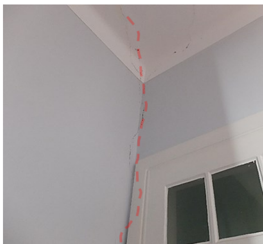
g) Fissuração entre paredes de alvenaria de pedra (pisso 2, corpo posterior)
