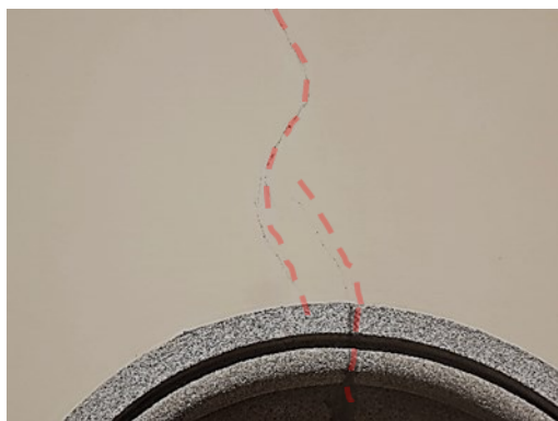
c) Fissuração na parede de fachada (corpo lateral Sudoeste)
