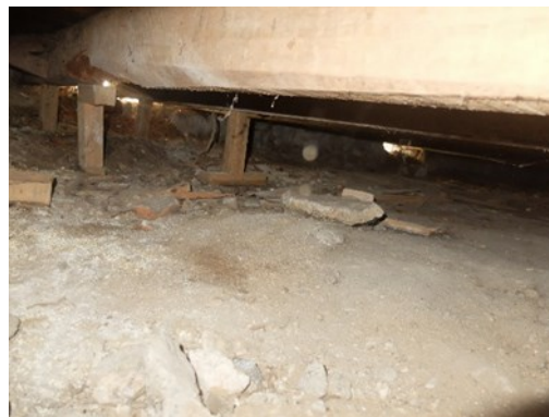
b) Degradação significativa nas vigas de madeira do piso 0 (corpo lateral sudoeste)
