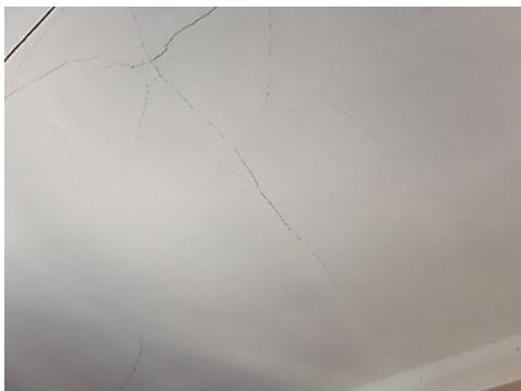
a) Fissuração generalizada no teto (corpo posterior)
