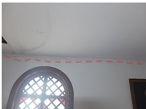
e) Fissuração no topo da parede da fachada exterior (pisso 1, corpo lateral Sudoeste)
