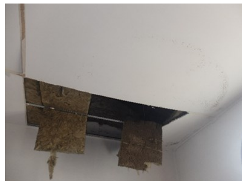
d) Teto existente com falta de material e manchas de humidade (corpo lateral)
