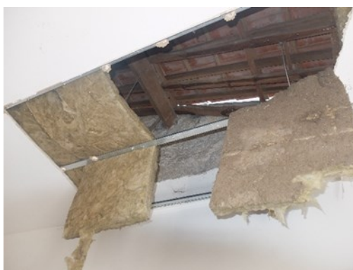
c) pormenor de falta de material no teto (corpo lateral sudoeste)
