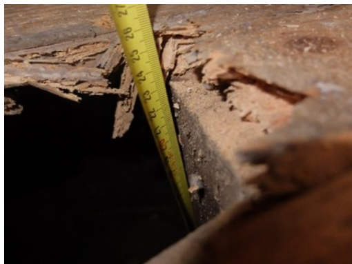
a) Degradação significativa do soalho em madeira do piso 0 (corpo lateral sudoeste)
