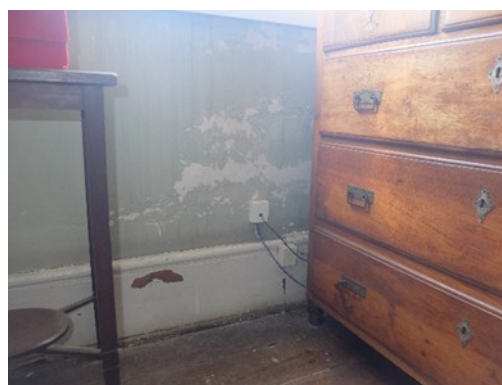
b) Manchas de humidade na parede de fachada (piso 1, corpo posterior)
