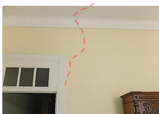
d) (Fissuração na parede de alvenaria interior (pisso 1, corpo posterior)
