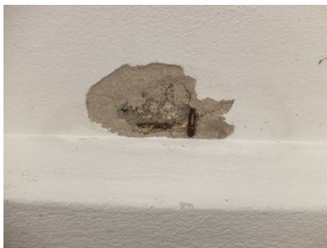
Figura 4.22 – Zona pontual da laje de patamar de escada exterior com destacamento do recobrimento e corrosão da armadura
