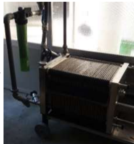
Figura 3.10 - Filtro de placas.
