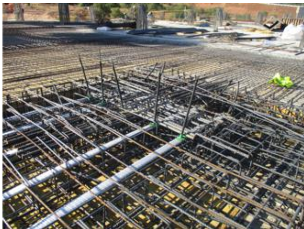
Figura 5.45 - Posicionamento de bainhas de cabos e colocação dos tubos de purga em laje
