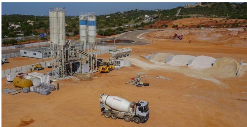
Figura 4.1 - Central de betão instalada em obra
