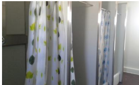
Figura 7.33 - Chuveiros nos balneários
