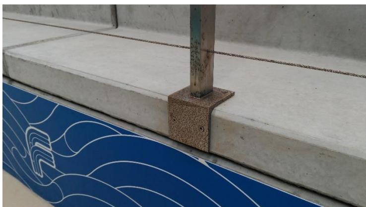
Figura 3-7 – Exemplo de fixação da guarda da bancada, com sinais de corrosão.
