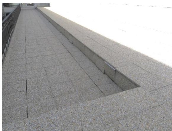
Figura 3-23 – Placas exteriores em granito deslocadas.
