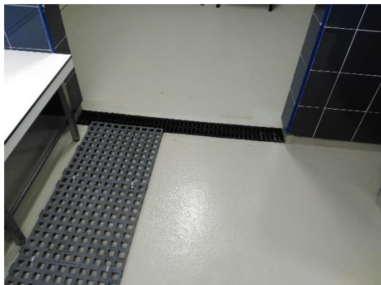
a) Grelha colocada na zona dos chuveiros.
