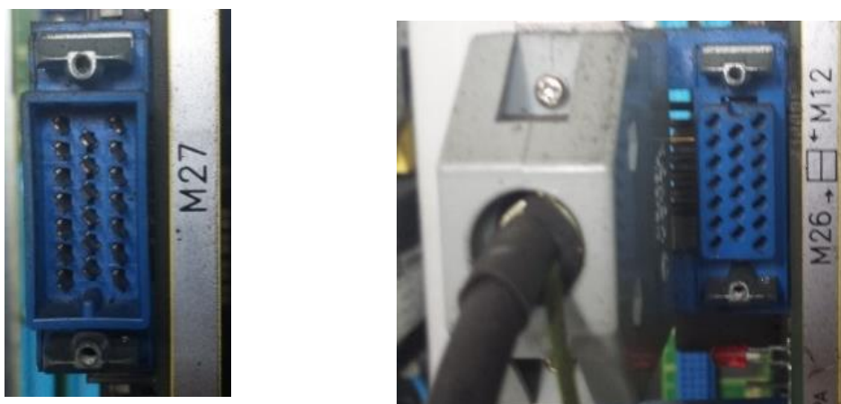
Figura 102 - Ligações de 21 pinos M26 e M27 no quadro do equipamento CNC
